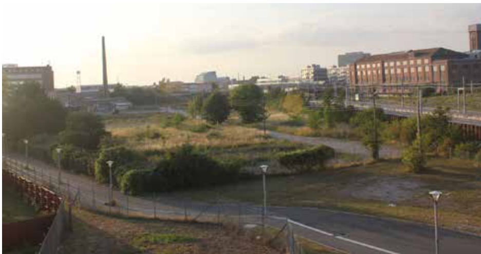
Frejas ejendom ved Følager set fra Ny Ellebjerg Station. Her er næsten al bebyggelse nedrevet.
