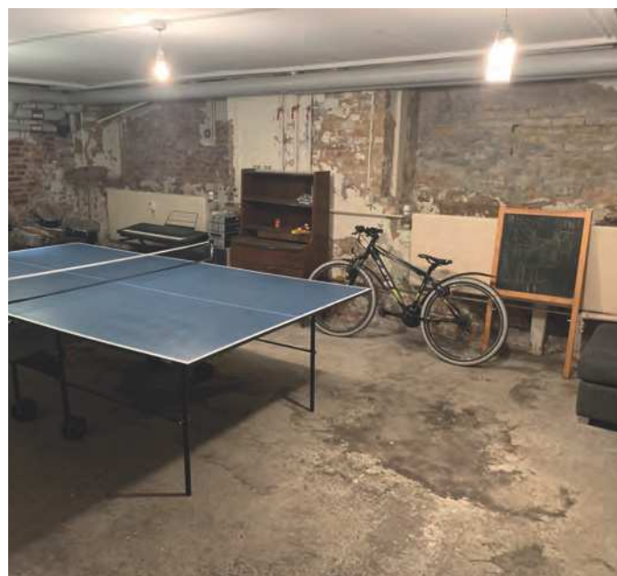
Fugtsikring af kælder
