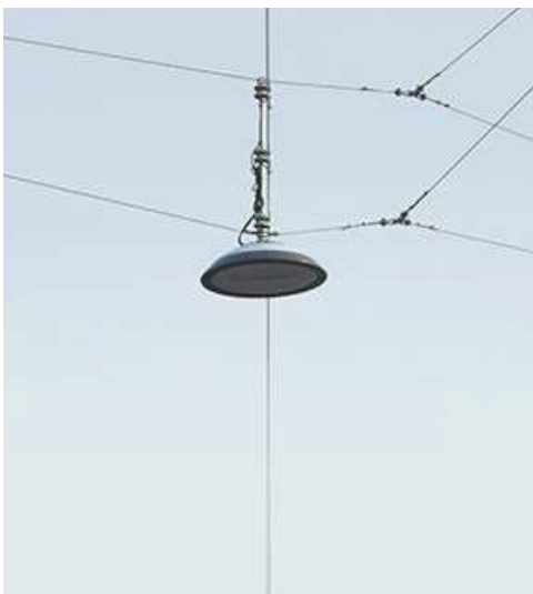
Eksisterende armatur 'Thor', Thorn Lighting
