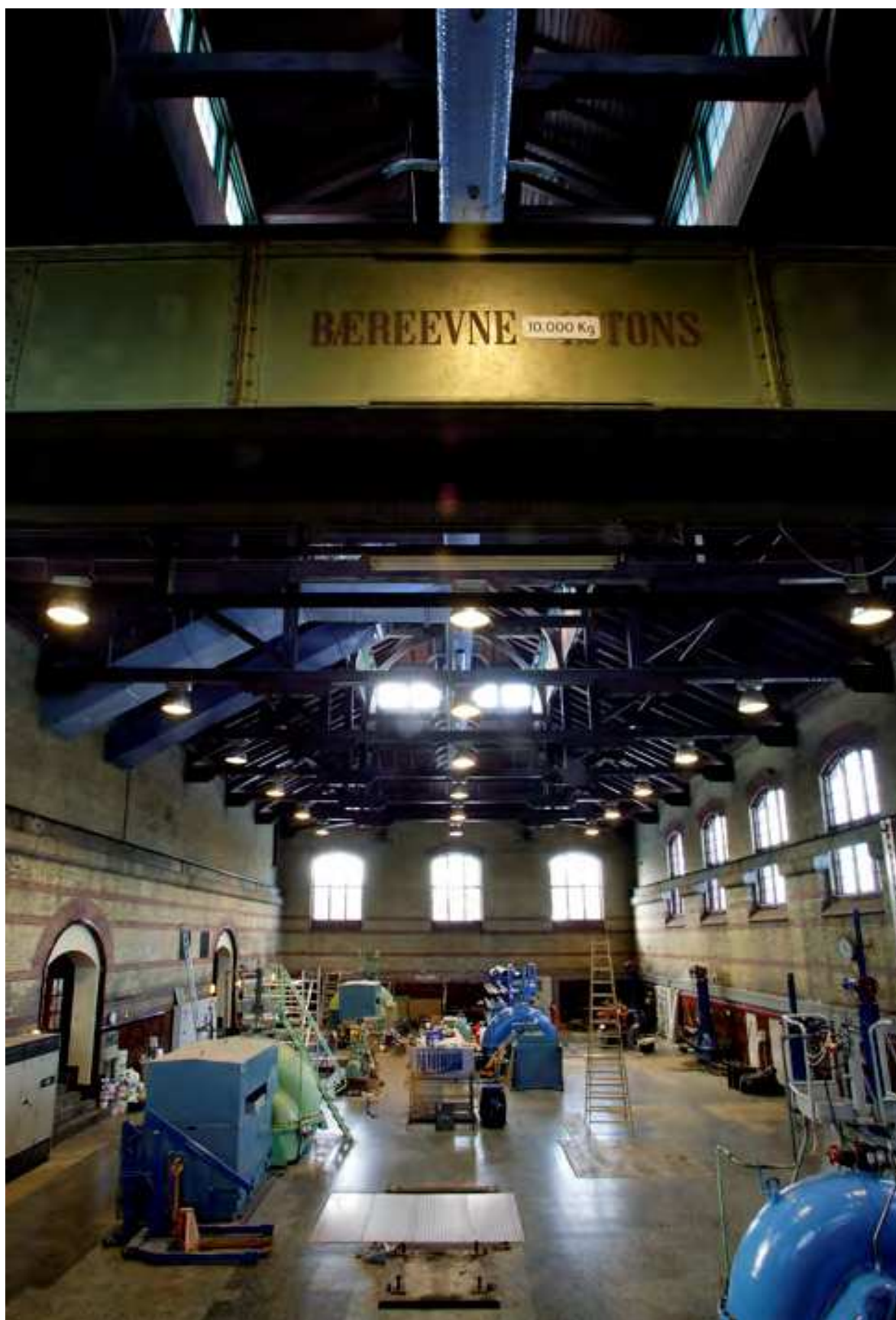
Foto 6 Maskinhallen på Kløvermarksvej Pumpestation
