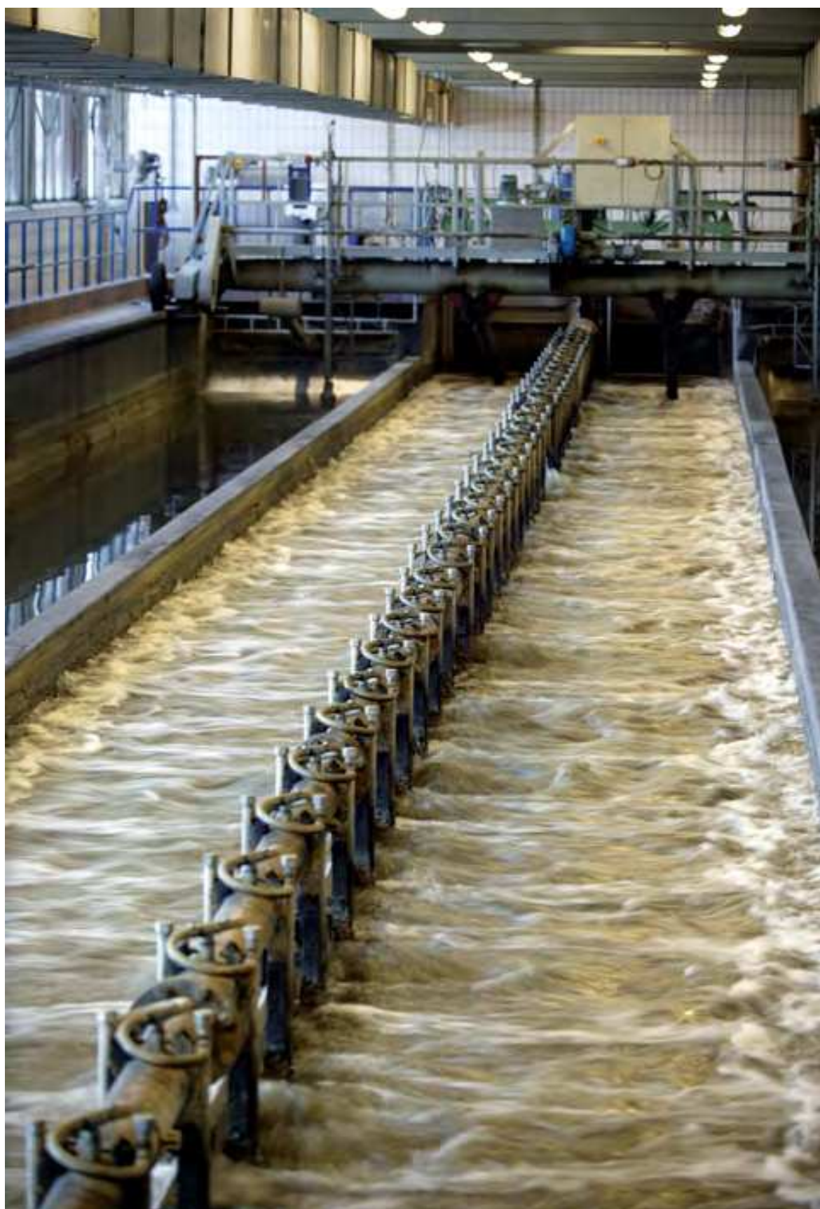
Foto 7 Sandfang på Strandvængets Pumpestation
