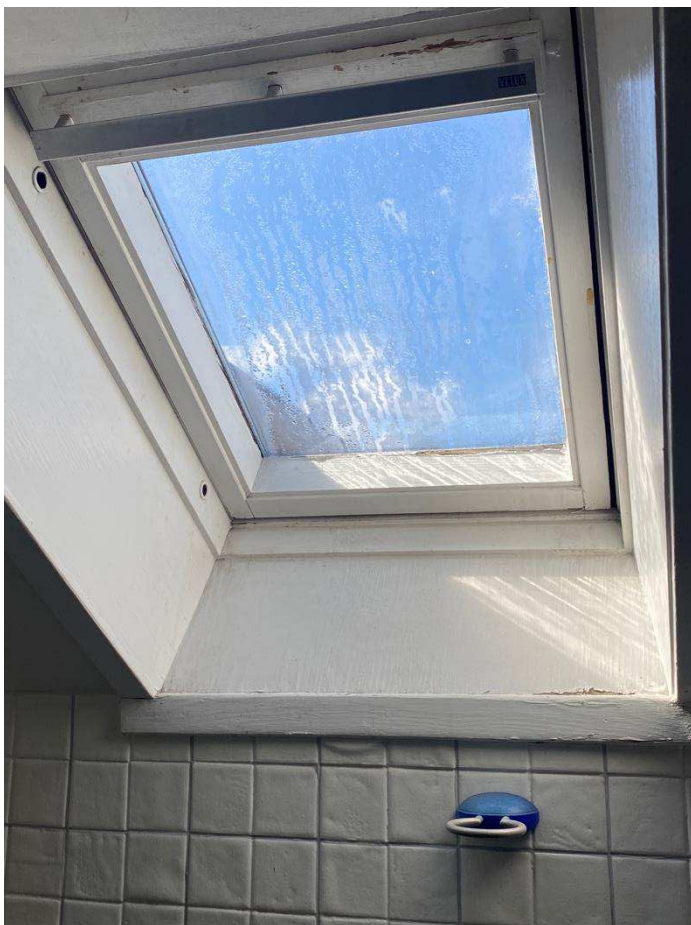
Fugtskader i vådrum
