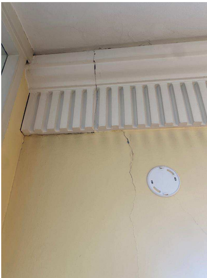
Sætningsrevner i kirkerum, gennemgående
