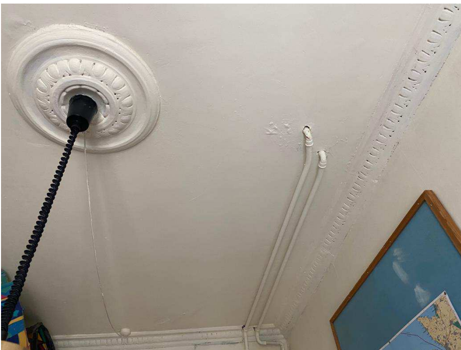
Fugtskader på lofter i bygning 1 + uhensigtsmæssige føringsveje
