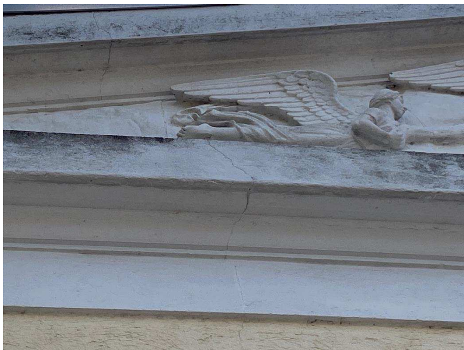
Udvendig sætningsrevne, bygningshjørne
