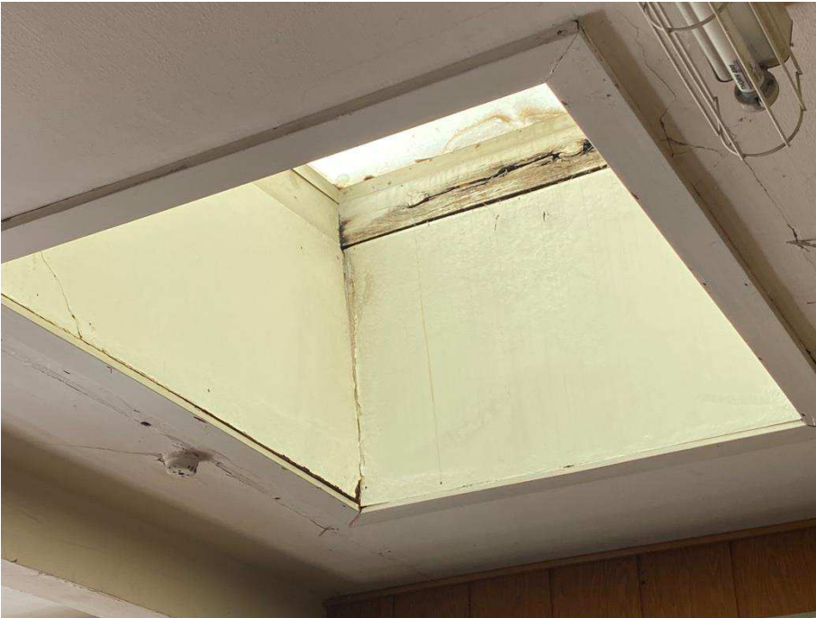
Rådskader i ovenlysvinduer i bygning 3
