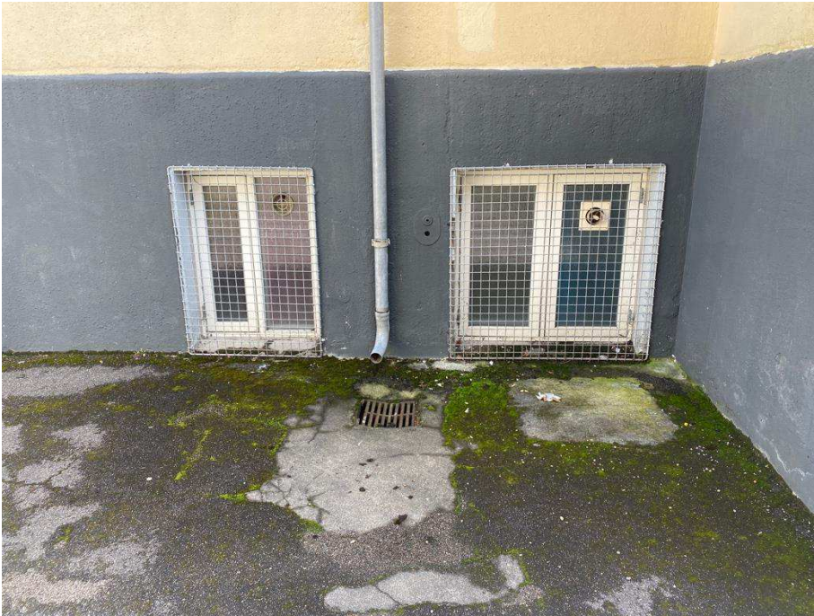
Vinduer med for lille opkant i forhold til terræn.
