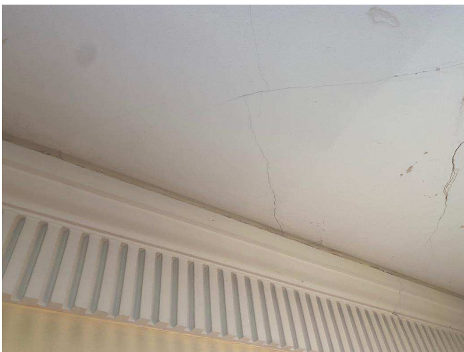
Sætningsrevner i kirkerum
