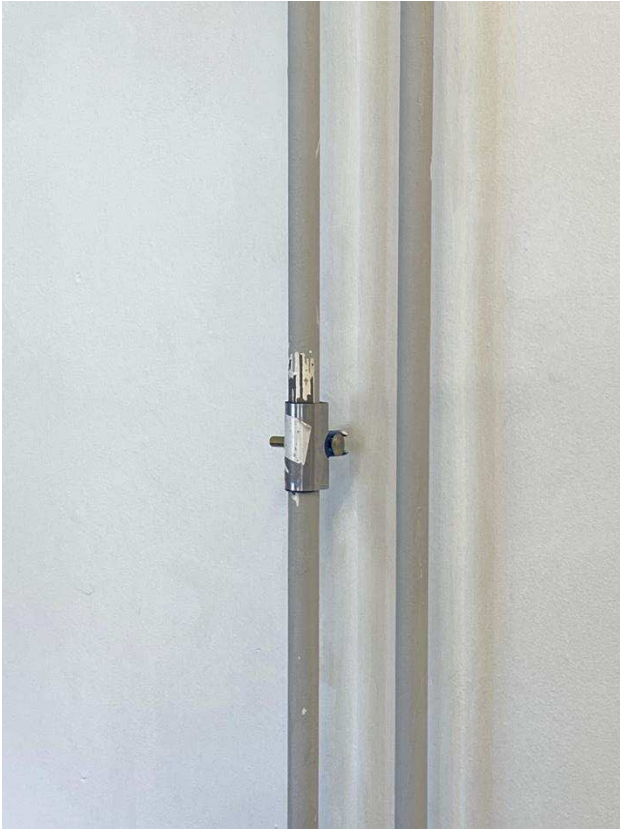
Begyndende tæring i varmerør – midlertidig lapning
