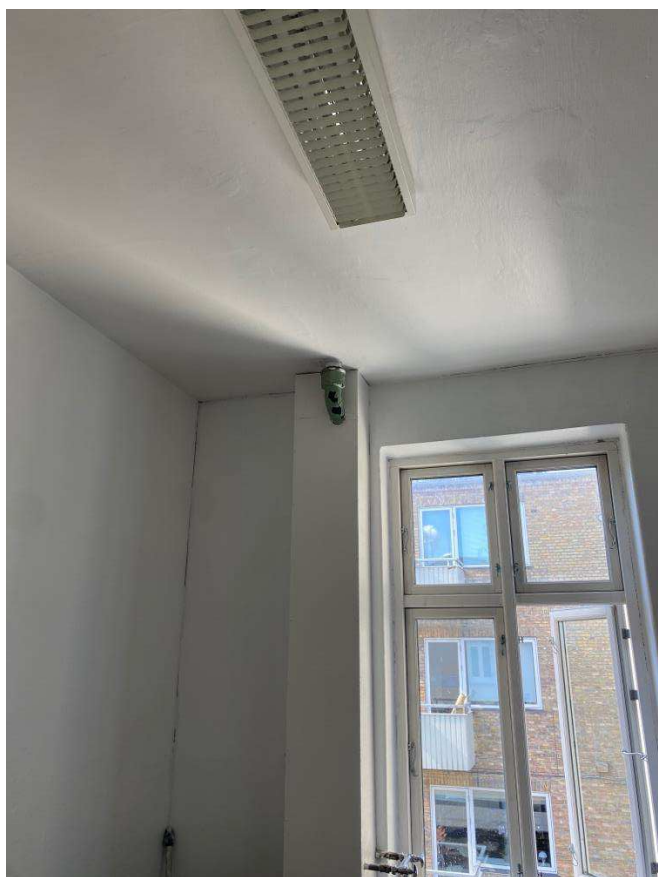
Faldstammer med begyndende gennemtæringer
