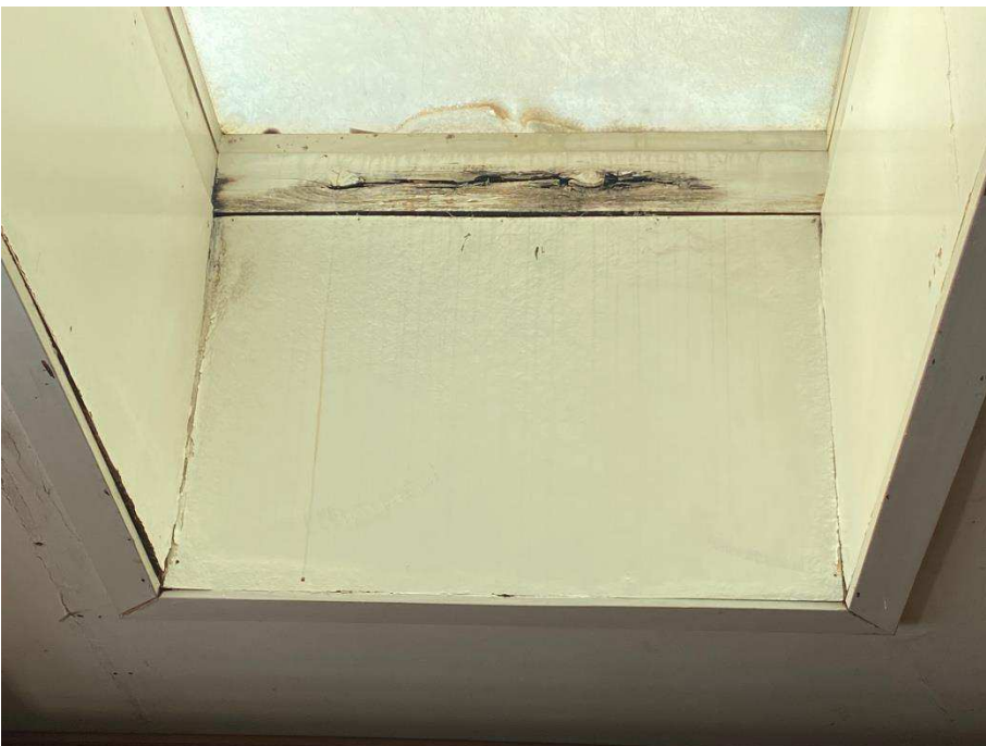
Rådskader i ovenlysvinduer i bygning 3
