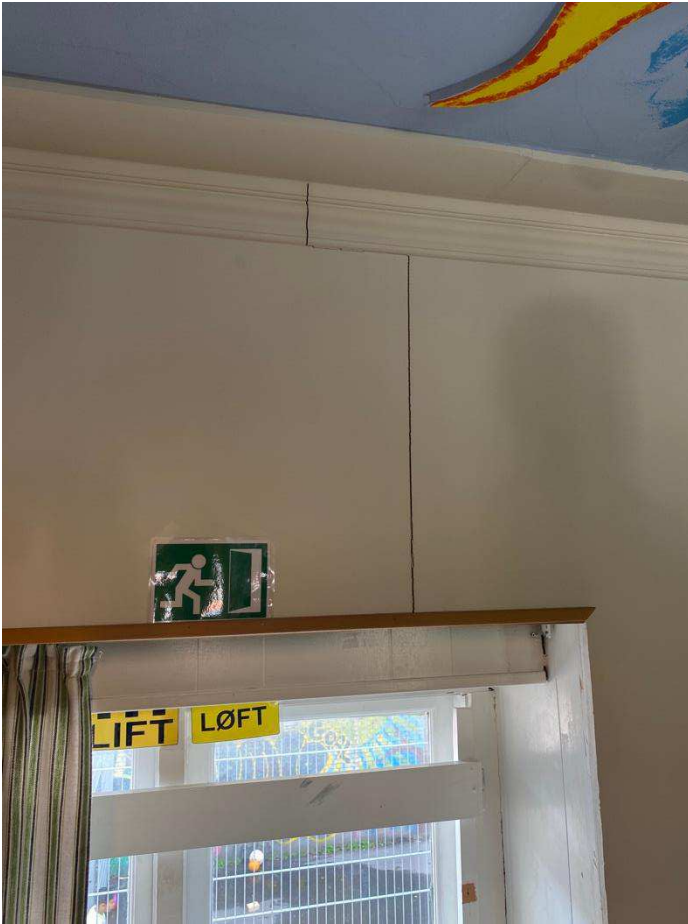
Sætningsevner i kirkebygning
