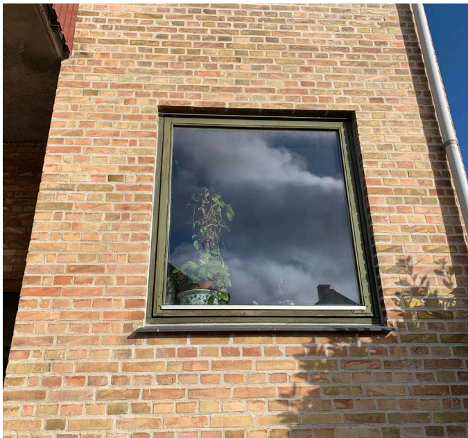
Eksempel på udtjent vindue
