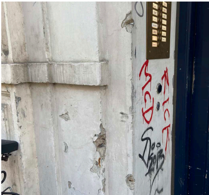
Facader er nedslidte
