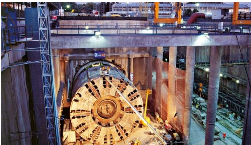
Figur 6.24 Tunnelgennembrud i modtagekammer. Projekt M30 i Madrid
