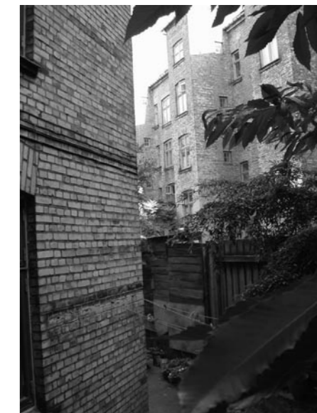
Gårdsiden af AB Prinsesse Charlottesgade 53-57, der rummer kondemnabile forhold i form af toiletter på bagtrappen.
