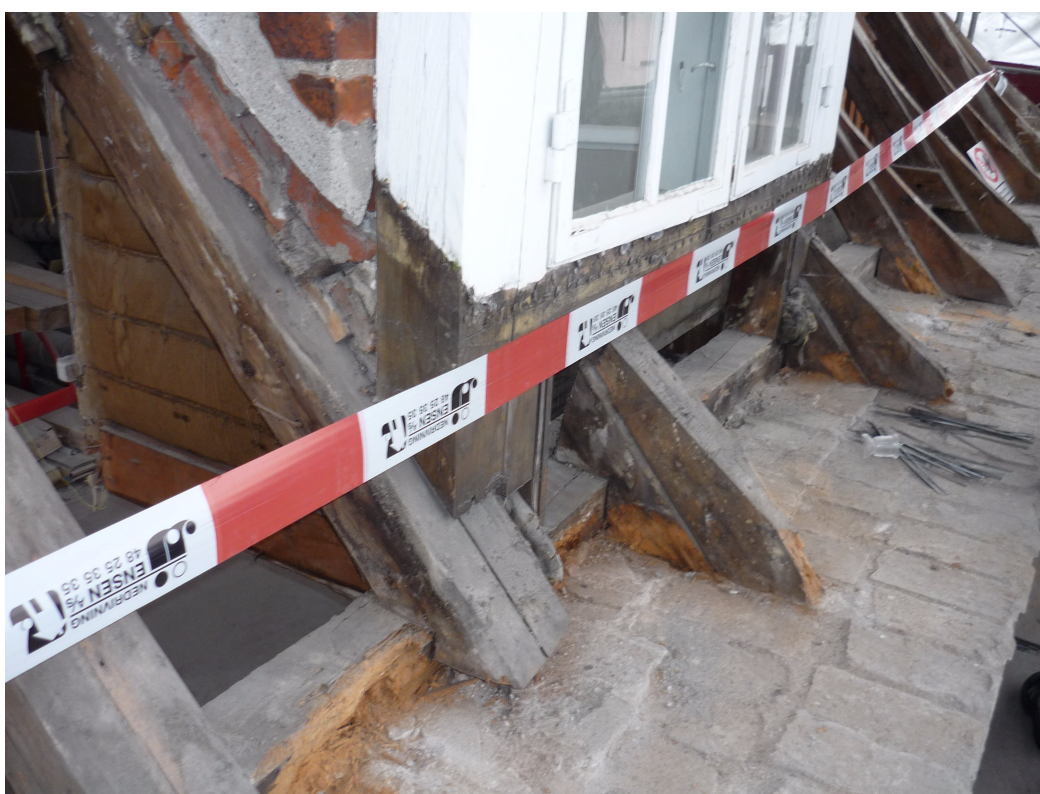
Rådskader i spærender og tagrem i Sundparkbygningen.
