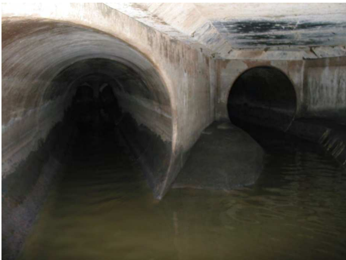
Foto 11 Ledningssammenskæring. To ledninger løber sammen til een
