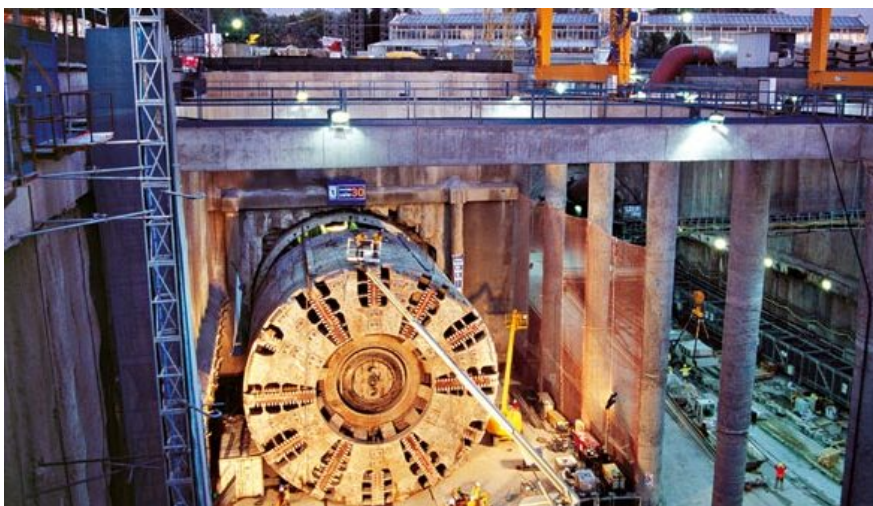
Figur 6.24 Tunnelgennembrud i modtagekammer. Projekt M30 i Madrid
