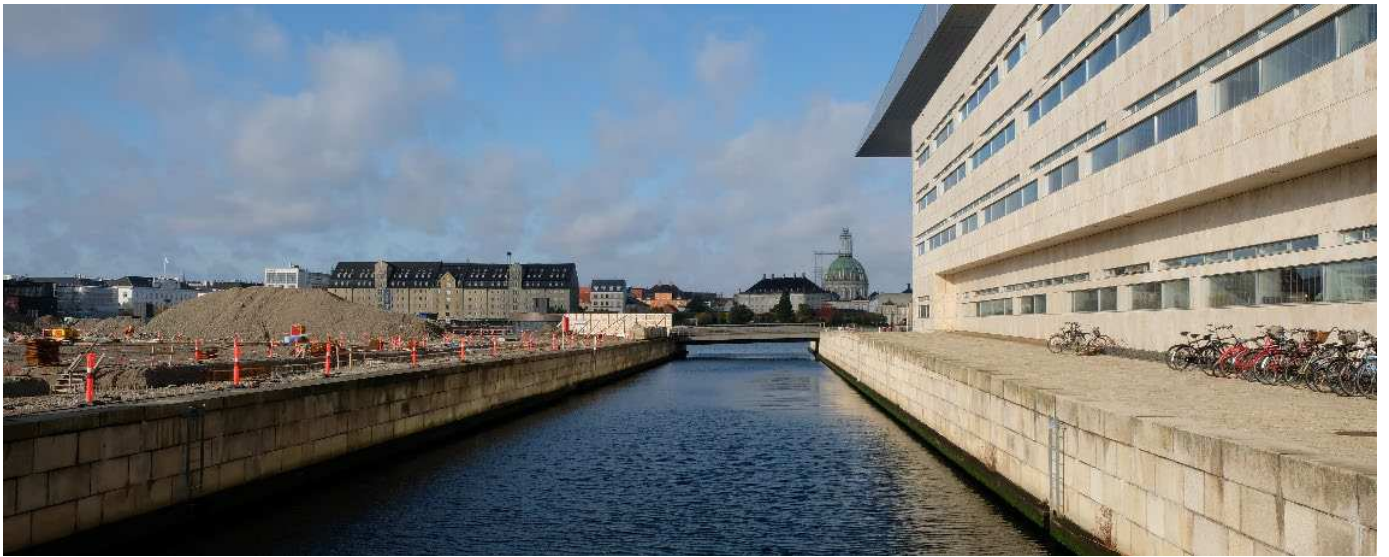
Operaen og Operaparken set fra broen mod Takkelloftsgraven. Den nye bro placeres parallelt med den eksisterende som ses på billedet.
