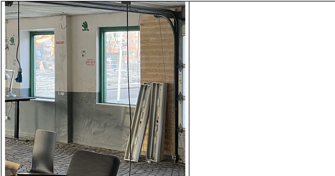
Billede 6 – Bygning 1 - Opstigende grundfugt i facadevæg
