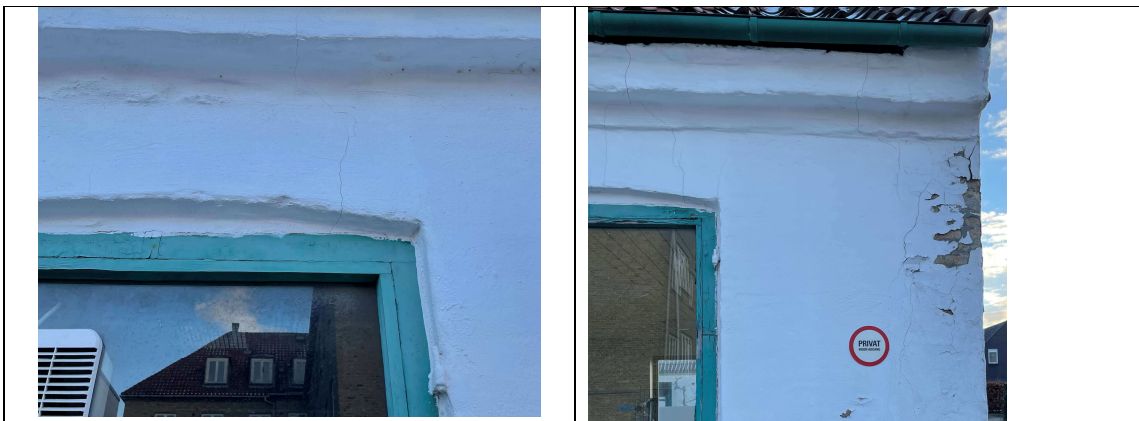
Billede 2 – Bygning 1 Revner omkring døre og vinduer
