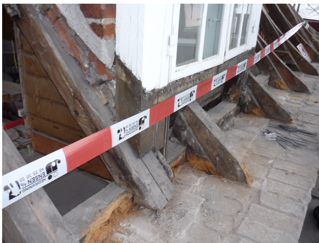
Rådskader i spærender og tagrem i Sundparkbygningen.
