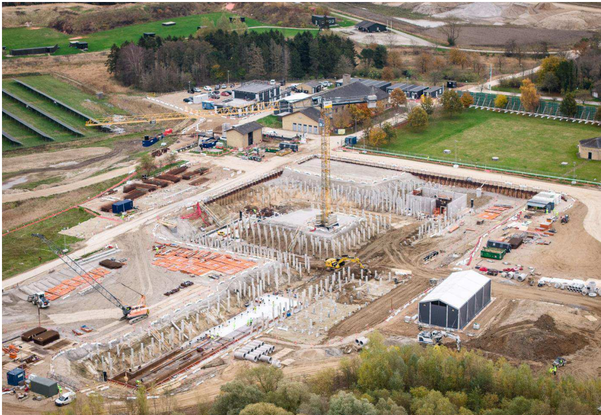
Figur 2 Foto fra november 2024. Opførelsen af kældergange og kapning af pæle er siden stort set afsluttet. Støbning af kældervægge pågår.
