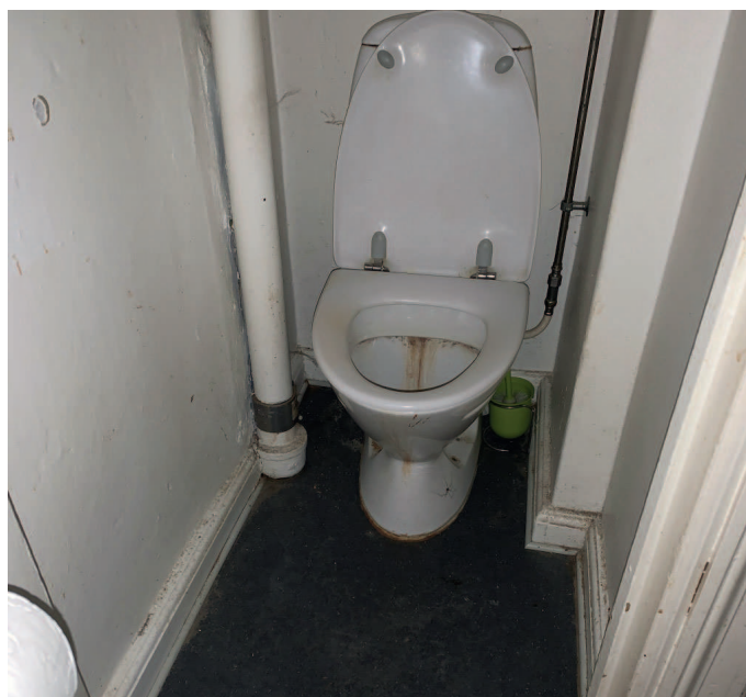
Indeliggende bad i 8 boliger, hvor der mangler
