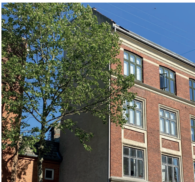
En af ejendommens uisolerede gavle
