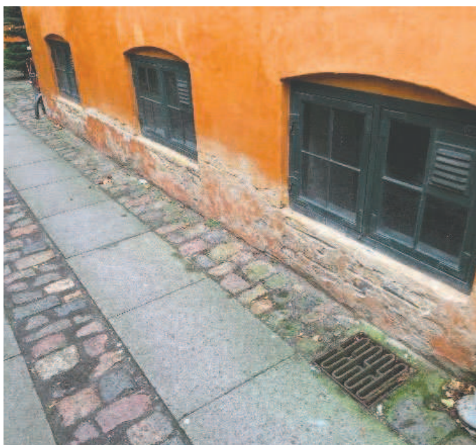
Den afskallede puds er tegn på fugtproblemer
