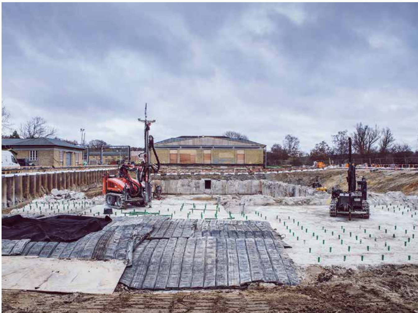
Der er gjort klar til den første sprængning af fundamentet på Vandværket ved Søndersø. Naboer blev inviteret med til at opleve sprængningen.
