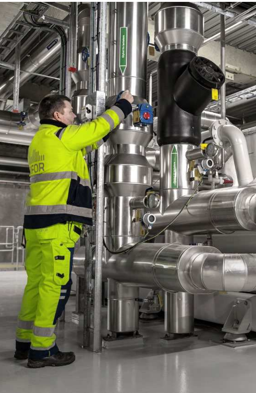
Fjernkølingsanlæg i Kranparken, København
