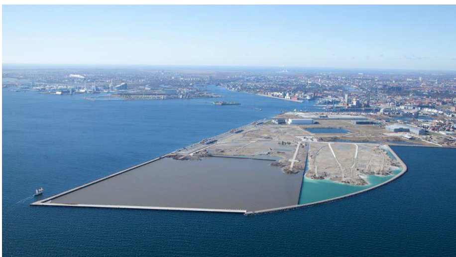
Opfyldningen ved Nordhavn set fra nord. Feltet til venstre er depot for forurennet jord, der drives af Københavns Kommune, og feltet til højre er depot for ren jord, der drives af By & Havn. (Foto: KMC Nordhavn)
