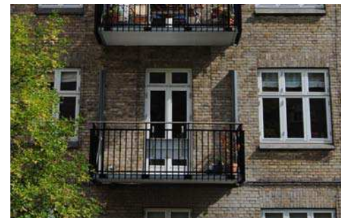
Billede nr. 5: Støttesøjler kan i nogle tilfælde være et nødvendigt alternativ til skråbæring.
