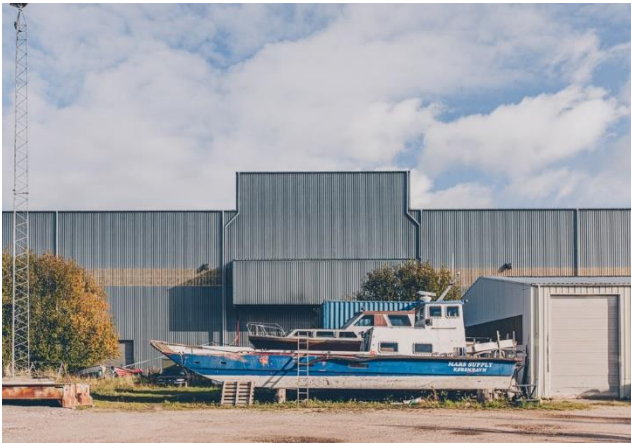
1.3 Fremspring i facade og tag. Sydfacade, Støbe- hallen
