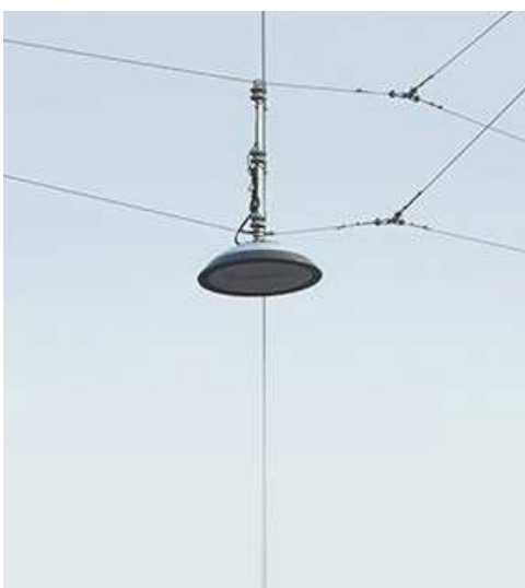
Eksisterende armatur 'Thor', Thorn Lighting
