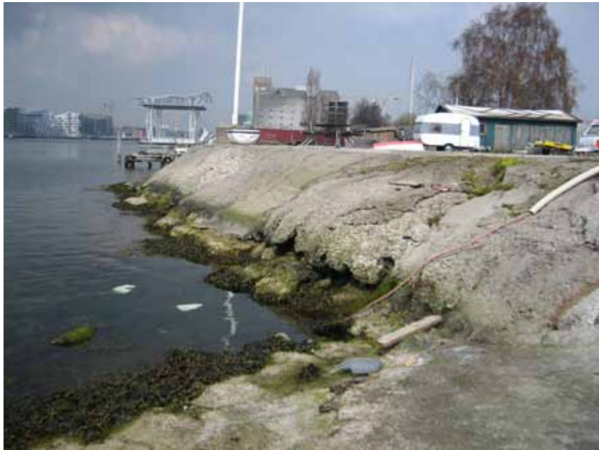
Betonkanten der flyder ud
