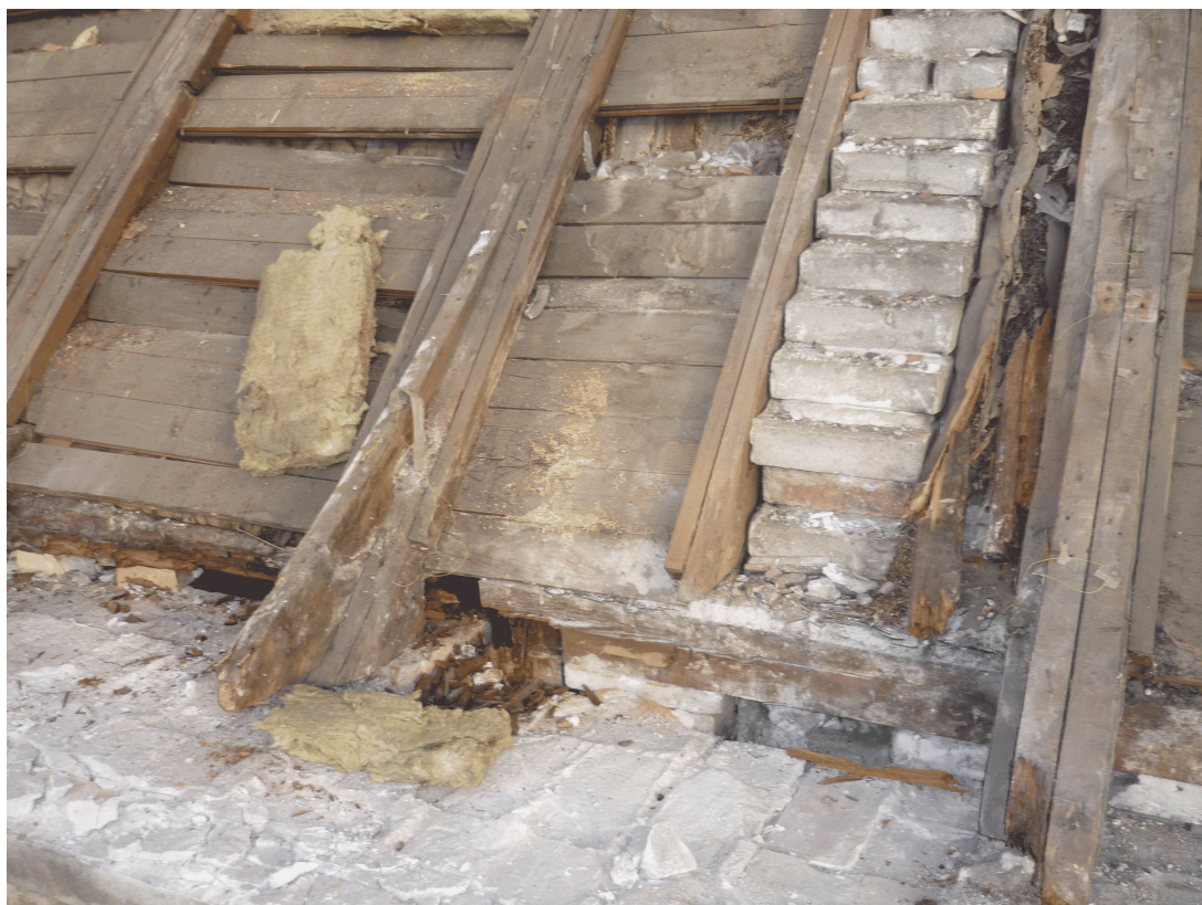
Råd og svampeskader i tagfoden i Sundparkbygningen.
