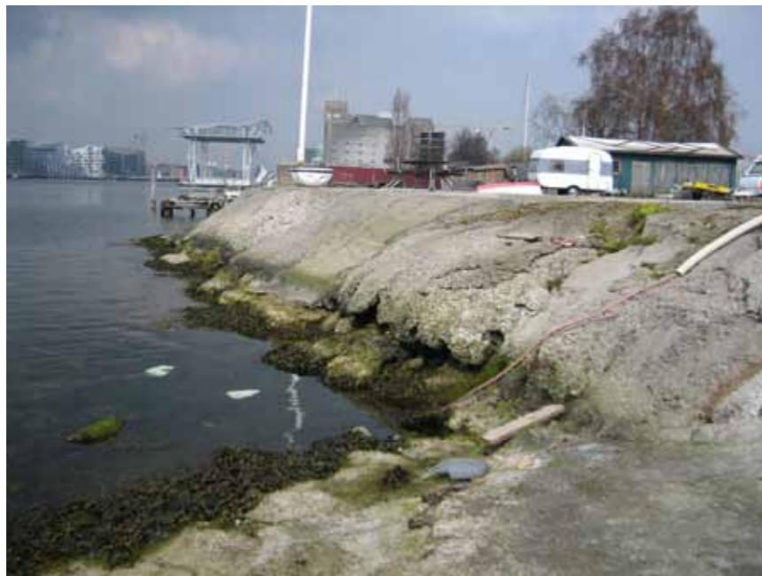
Betonkanten der flyder ud
