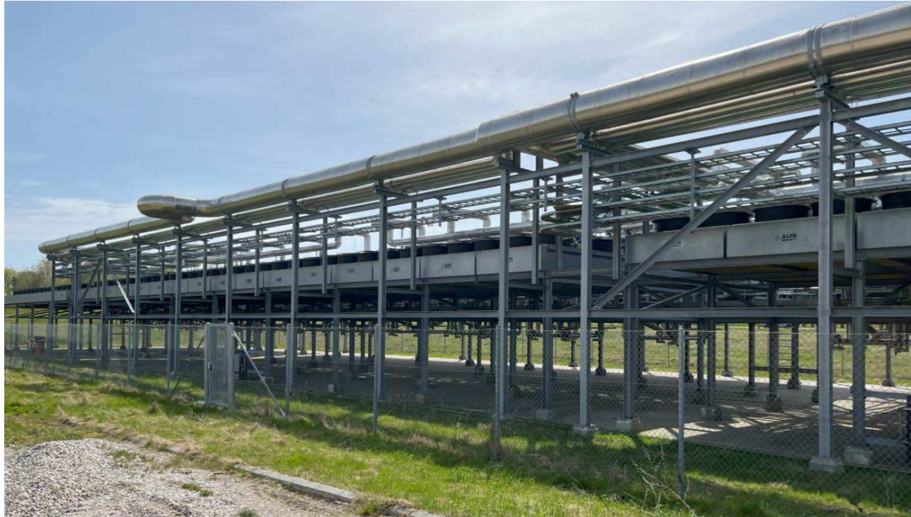
Figur 19 Luftoptag til luft/vand-varmepumpe på cirka 10 MW.
