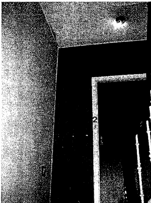
Typisk trapperum. Der mangler malerbehandling og pudsreparationer.
