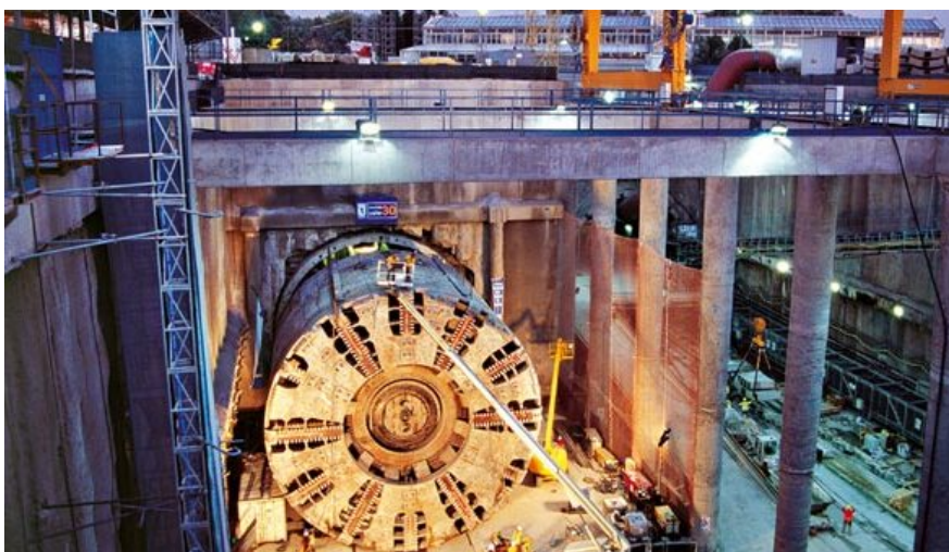
Figur 2.4 Eksempel på tunnelgennembrud ved en boret tunnel.
