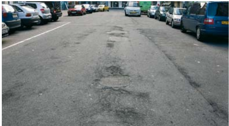
Slaghuller og revner, Heimdalsgade
