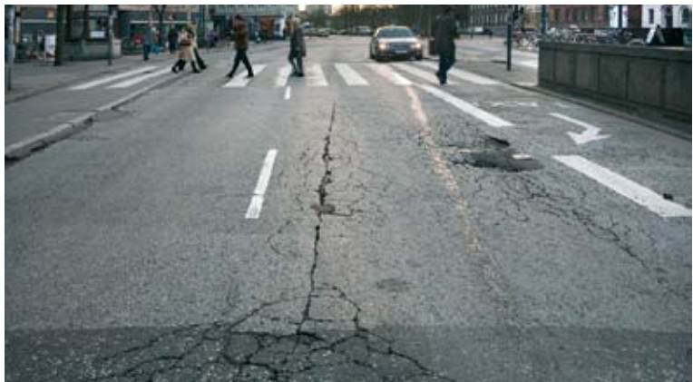
Revner og krakeleringer, Nørre Voldgade
