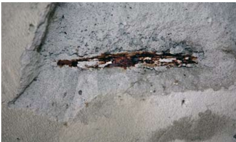
Billede fra gangtunnel under Sølvgade ved Riensgade der viser voldsomme armeringskorrosion i den bærende overbygning med betonafskalning som følge.
