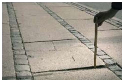
Fortov med farligt opspring
