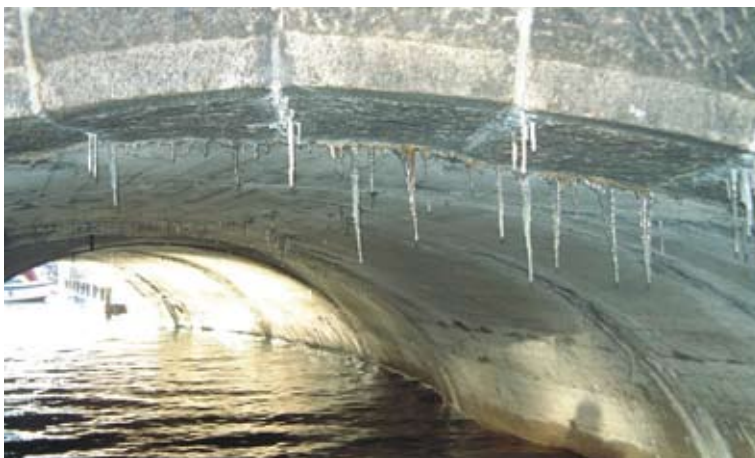
Billede fra Stormbroen der viser voldsomme gennemsvinninger af vand der er med til at udvaske betonen i den bærende overbygning med drypsten som følge.
