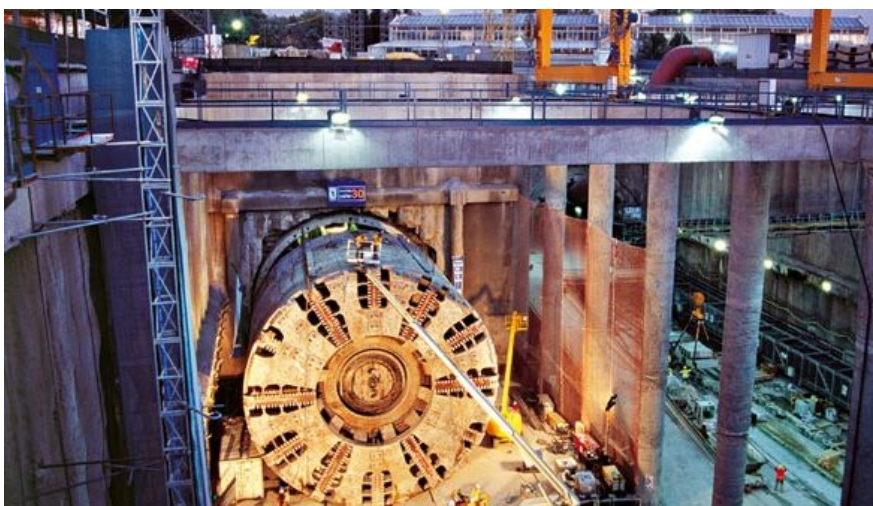
Figur 2.4 Eksempel på tunnelgennembrud ved en boret tunnel.
