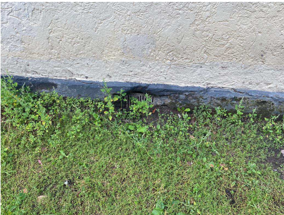
Ventilationsriste, for lavt sittende i forhold til terræn
