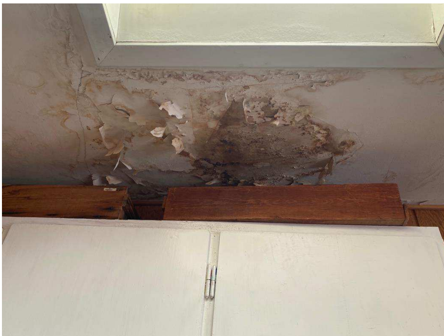
Omfattende fugtskader på lofter i bygning 3
