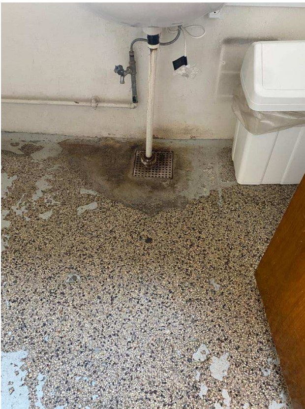
Installationer med gennemtæring
