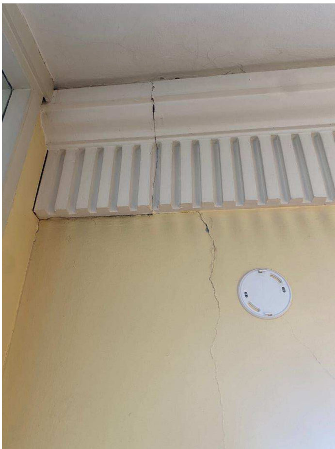
Sætningsrevner i kirkerum, gennemgående
