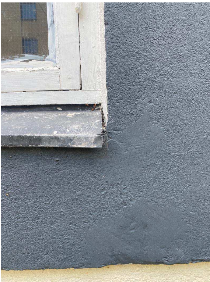
Utilstrækkelige inddækninger ved facadepartier, med risiko for vandindtrængen
