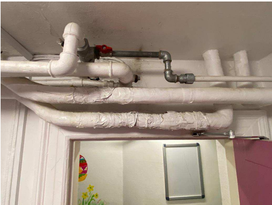
Installationer i kælder – slidte og begyndende gennemtæringer
