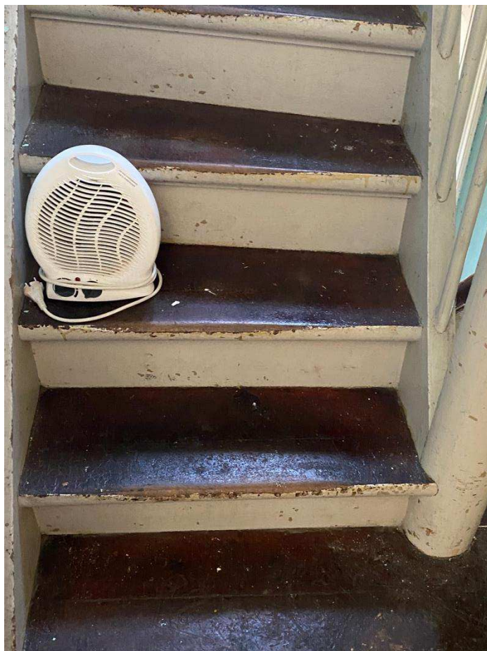
Nedslidte bygningsdele – trappe bygning 1
