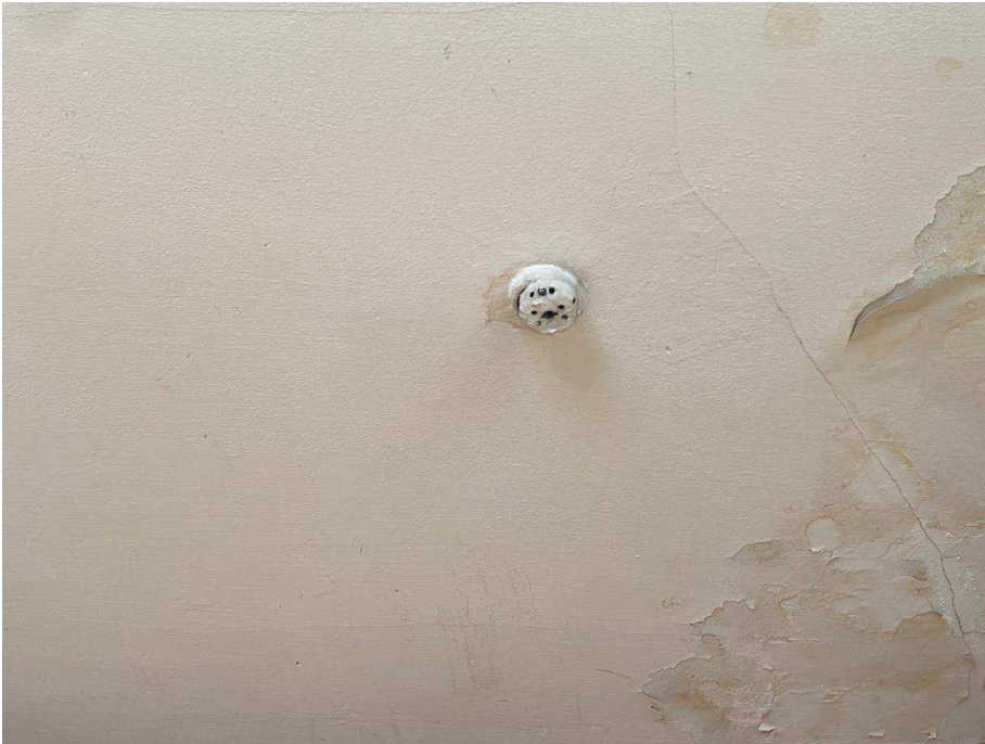
Udtjente og utidssvarende elinstallasjoner
