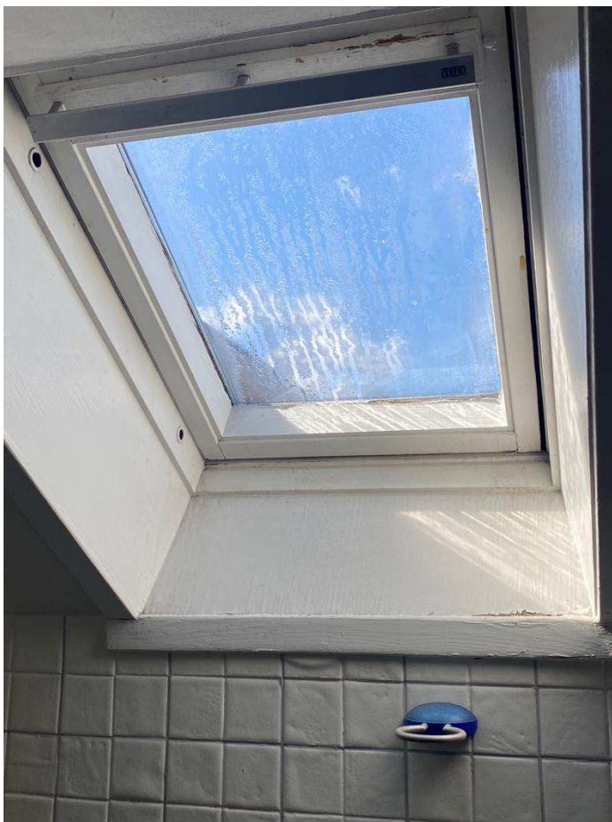
Fugtskader i vådrum
