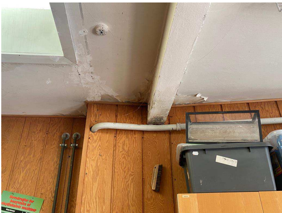
Fugtskader på lofter i bygning 3
