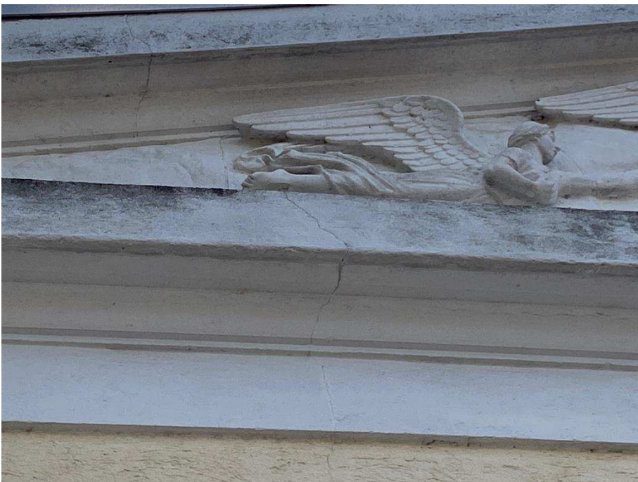
Udvendig sætningsrevne, bygningshjørne
