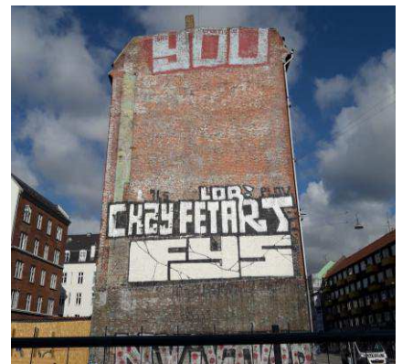
Billede fra stedet - Ikonisk gavl mod Svanevej 2. Byggearbejdet for 41 ungdomsboliger er netop begyndt.
