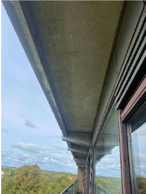
Figur 8. Udhænget af det flade tag over en balkon på den øverste etage. Der er ingen sprækker eller revner der muliggør adgang til et loftsrøm.
