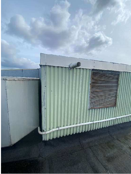
Figur 5. Bygningen som indeholder udluftningssystemet er lukket effektivt af mod omgivelserne.
