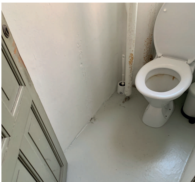
Indeliggende WC og bad i 36 boliger, hvor der mangler
