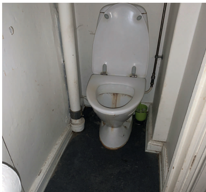
Indeliggende bad i 8 boliger, hvor der mangler
