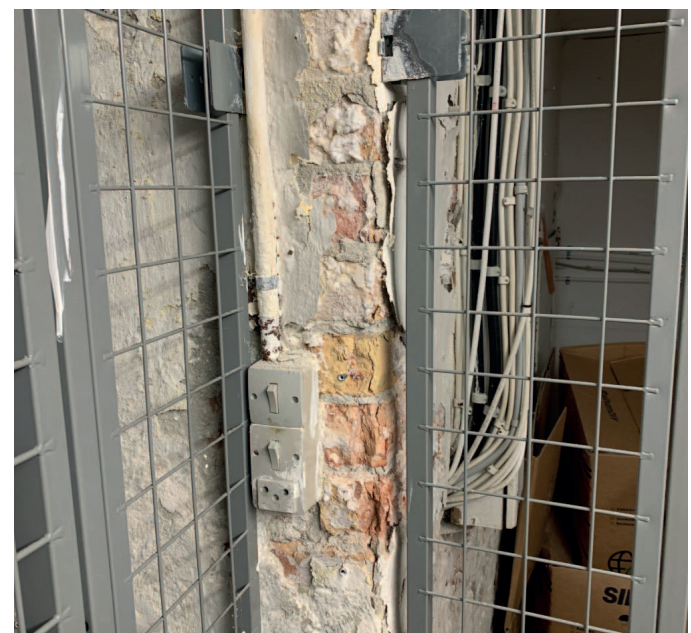
Fugtsikring af kælder
