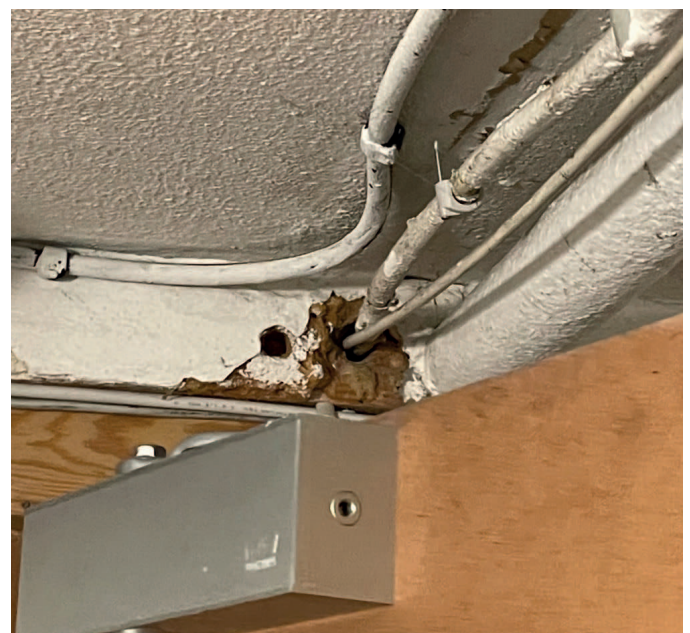
Manglende brandsikring af gennemføringer i kælder
