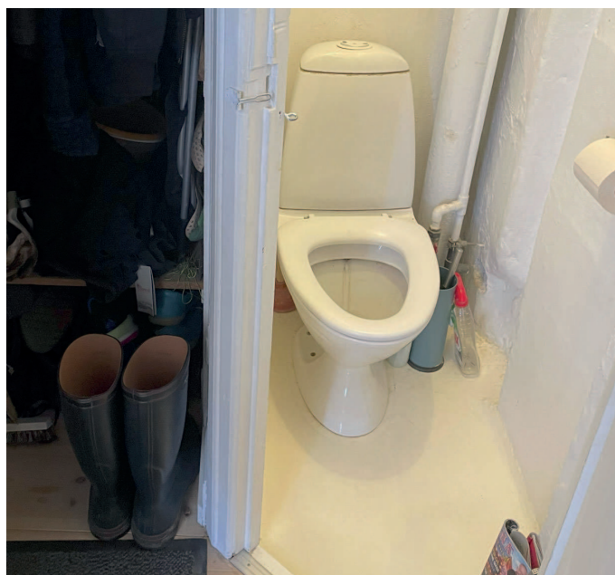
Indeliggende bad i 12 boliger, der mangler
