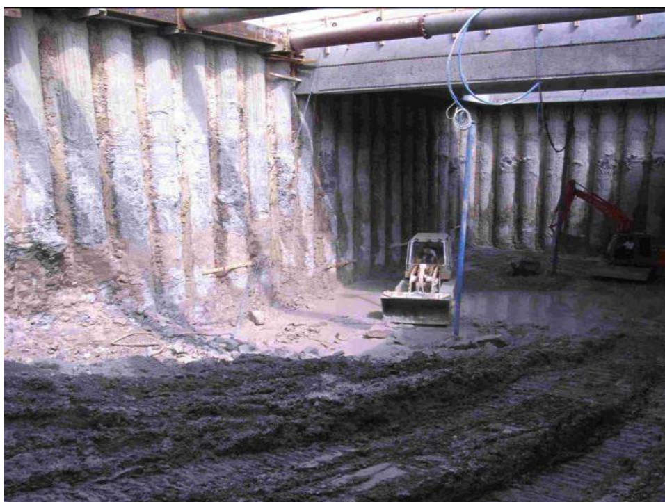
Figur 4.13 Udgravning af stationsboks mellem primære støttevægge udført med sekantpæle i armeret beton, Københavns Metro.
