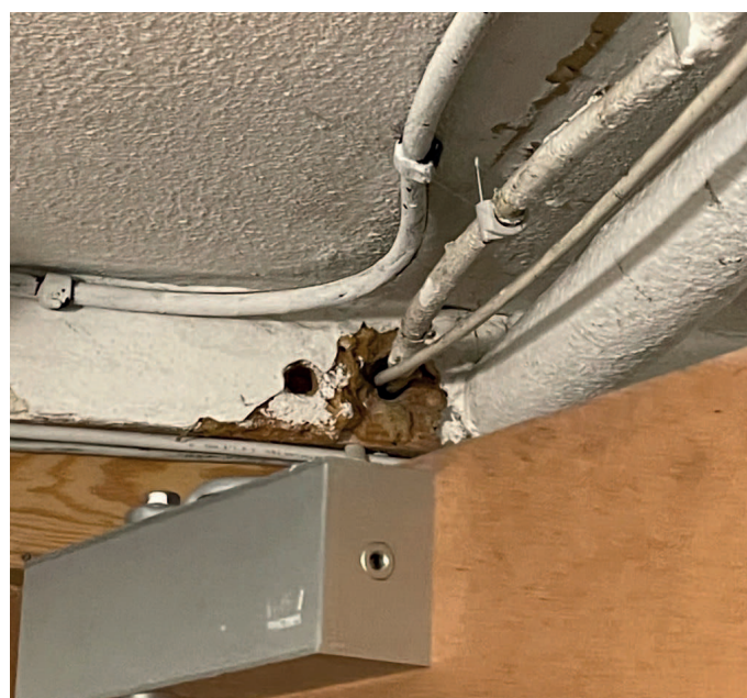
Manglende brandsikring af gennemføringer i kælder
