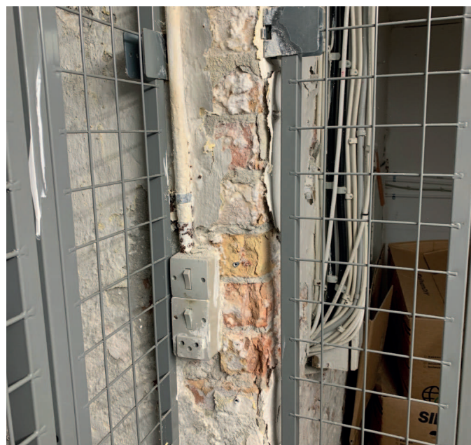
Fugtsikring af kælder
