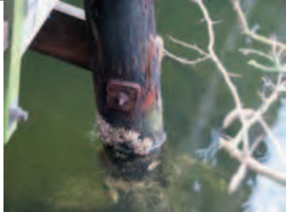
Foto 64: Kraftig korrosion i fastgørelsesbeslag til krydssamling i mellemunderstøtning.
