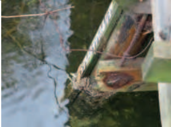
Foto 63: Kraftig korrosion i fastgørelsesbeslag til krydssamling i mellemunderstøtning.
