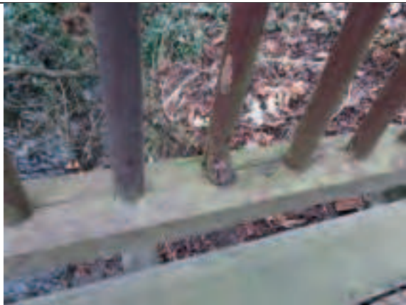
Foto 61: Knækket balustre pga. råd fra dårlig samlingsdetalje
