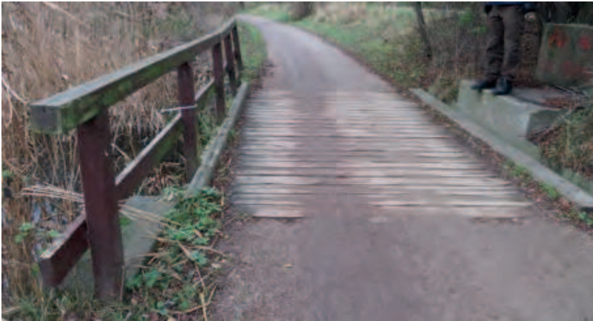
Foto 43: Oversigtsfoto; Bro set fra øst. Rækværk vælter ud og sidder løst.
