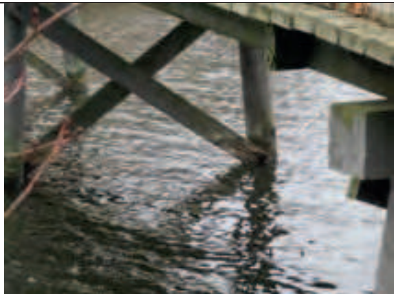
Foto 37: Lettere forvitring af mellem understøtning ved vandniveau.
