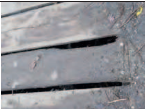
Foto 53: Brodæk i vest er i meget ringe stand. Flere planker med forvitret kanter og flere med råd. Jord ligger på plankerne.
