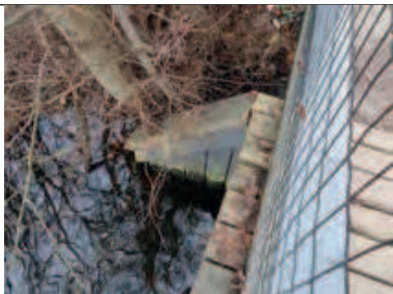
Foto 39: Tegn på råd ved fløjvæg i nordlige ende ved vandniveau.
