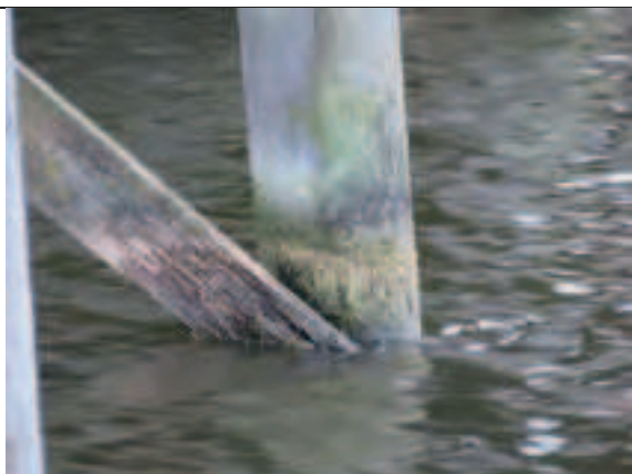
Foto 38: Lettere forvitring af mellem understøtning ved vandniveau.
