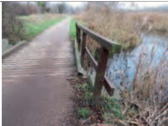
Foto 45: Betonfløj i sydvest vælter udad, hvilket formodentlig skyldes underminering
