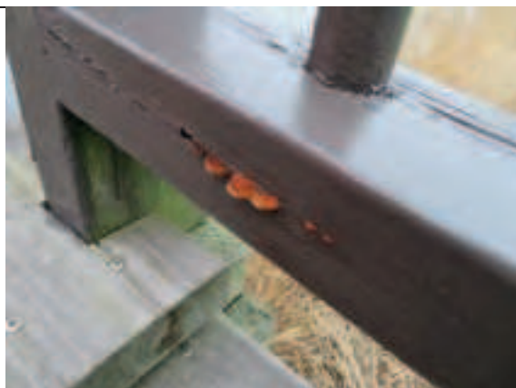
Foto 78: Fodliste med svampeskade (korkhat), hvilket skyldes vand trænger ind i fodlisten ved iboret balustre.
