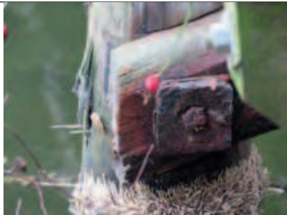
Foto 66: Kraftig korrosion og revne i fastgørelsesbeslag til mellemunderstøtnings kryds.
