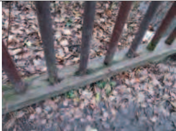
Foto 56: Råd i balustre og fodliste, hvilket skyldes at balustre er iboret fodlisten, hvor vand trænger ind og nedbryder træet.
