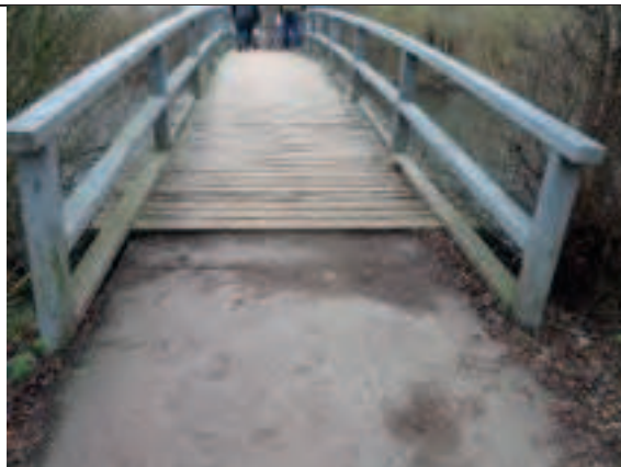
Foto 31: Sætninger i asfalten ved nordlige broende, hvilket kan skyldes underminering af endevederlag. Råd og forvitring i enkelte planker i brodækket.
