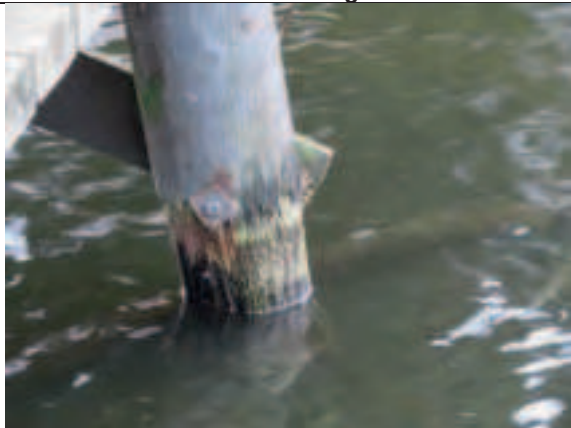
Foto 34: Lettere forvitring af mellem understøtning ved vandniveau.
