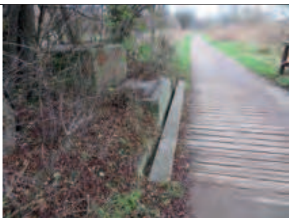
Foto 46: Overløbs konstruktion for skybrud er fyldt med jord og blade, hvilket bør oprensnes.
