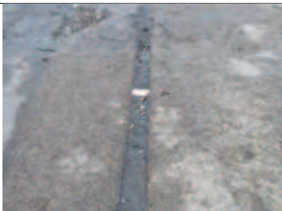
Foto 27: Aqua-drain tilstoppet, hvilket skyldes manglende renhold.
