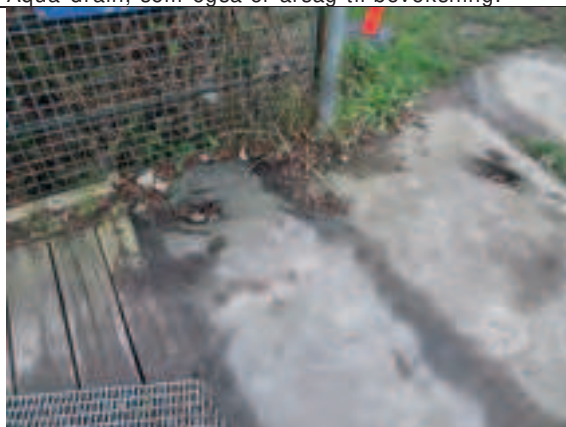
Foto 28: Hul i asfalt belægning, hvilket tyder på erosion bag endevederlag i nordlige ende
