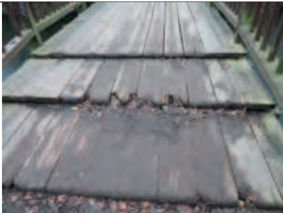
Foto 51: Brodæk i øst er i meget ringe stand. Flere planker knækket og flere med råd
