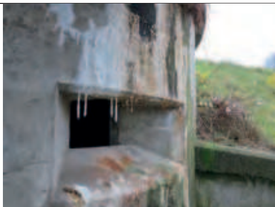
Foto 74: Endeunderstøtning i nordvest (bunker/skydehuller): Gennemslivninger og hvide kalkudfældninger i betonen.
