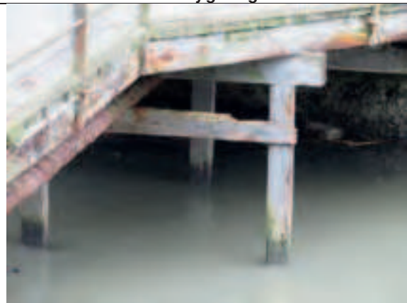
Foto 17: Råd i tværbjælke og deraf reduceret tværsnit.
