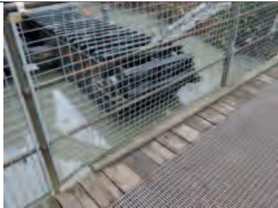
Foto 22: Pressegitter udfyldning knækket samt ikke forsvarligt fastgjort i bunden og kan dermed vippes op.
