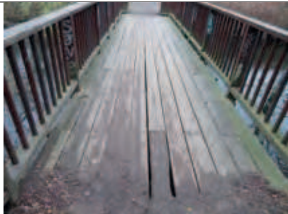
Foto 52: Brodæk i vest er i meget ringe stand. Flere planker med forvitret kanter og flere med råd. Jord ligger på plankerne.
