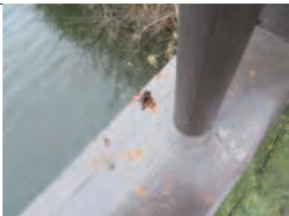
Foto 77: Fodliste med begyndende svampeskade (korkhat), hvilket skyldes vand trænger ind i fodlisten ved iboret balustre.
