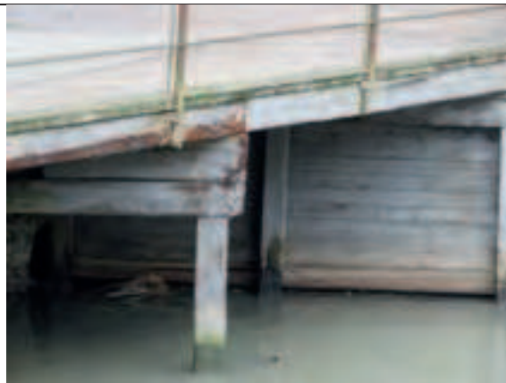
Foto 18: Mellemunderstøtninger med reduceret tværsnit ved vand niveau.
