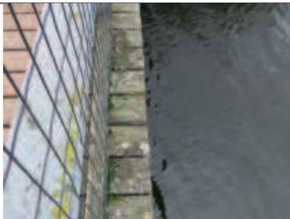
Foto 33: Algevækst på yderside af plankedæk pga. manglende renhold.
