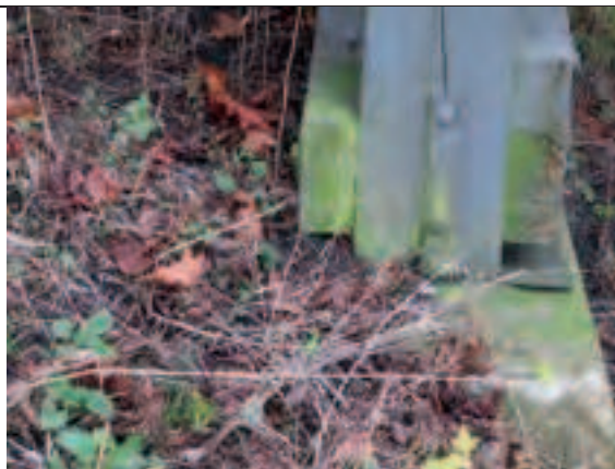
Foto 14: Tværplanke til mellemunderstøtning i østlige ende bør fri graves for jord.
