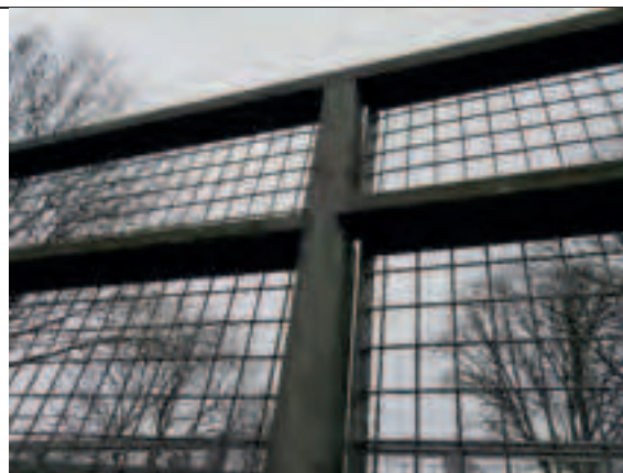
Foto 10: Knæliste skubbet udad, hvilket er til fare for trafikanter kan falde i vandløbet. Bør fastgøres hurtigst muligt.
