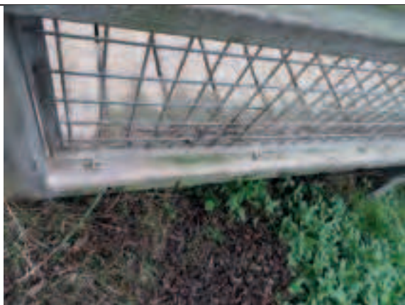
Foto 9: Skruer mangler til fastgørelse af pressegitre, hvilket er til fare for at børn kan falde i vandløbet. Bør fastgøres hurtigst muligt.
