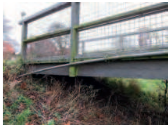
Foto 15: Trækrør på yderside bro sidder løst, hvilket bør gennemgås for manglende skruer.
