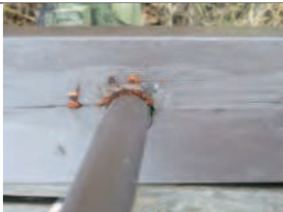
Foto 76: Balustre med svampeskade (korkhat), hvilket skyldes vand trænger ind i fodlisten ved iboret balustre. Dette er en generelt en dårlig løsning.
