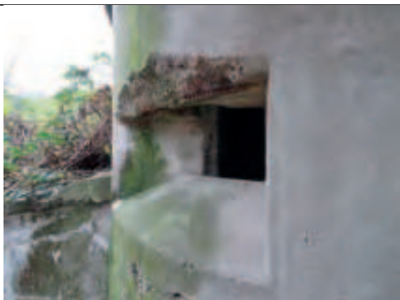
Foto 73: Endeunderstøtning i sydvest (bunker/skydehuller): Grov afskalning af beton og frilagt armering ved overligger til skydehul til bunker.
