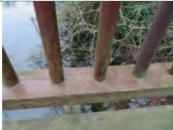
Foto 62: Knækket balustre pga. råd fra dårlig samlingsdetalje
