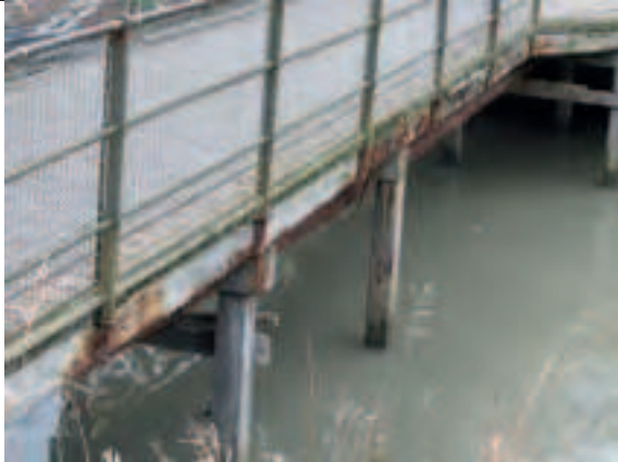
Foto 19: Rækværksceptres fastgørelse fremstår med kraftig korrosion og tværsnitsreduktion. Kraftig korrosion i trækrør på underside bro.
