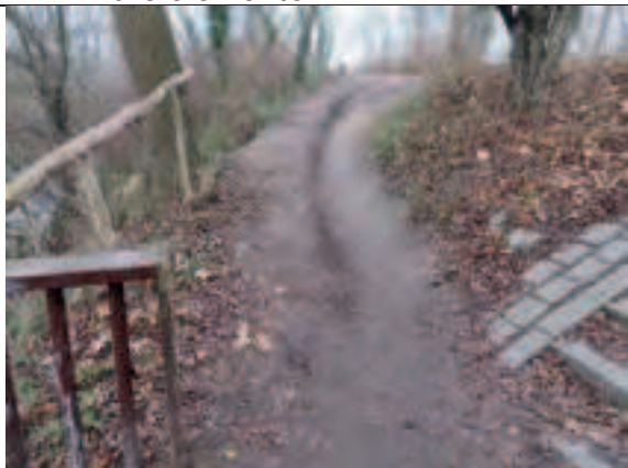
Foto 67: Nedkørselssti i sydvestlige ende med rækværk. Rækværket er meget spinkelt og lever ikke op til nødvendige bæreevne.
