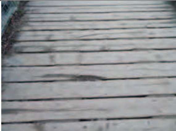
Foto 5: Plankedæk. Meget ujævn og generelt forvitret.
