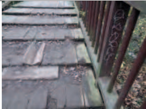
Foto 50: Brodæk i øst er i meget ringe stand. Flere planker knækket og flere med råd
