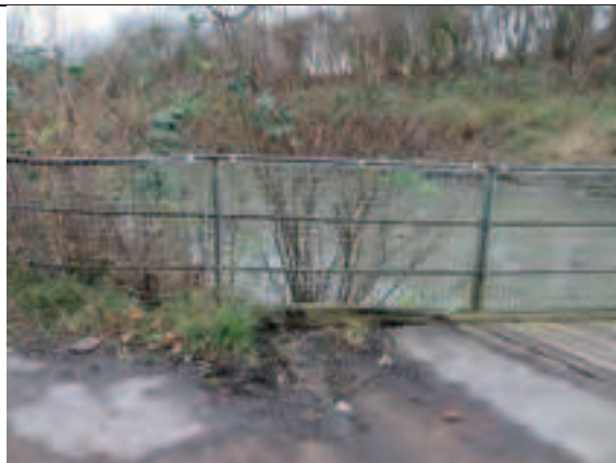
Foto 26: Sætninger i belægning og råd i kantbjælke skyldes manglende afledning af vand pga. tilstoppet Aqua-drain, som også er årsag til bevoksning.
