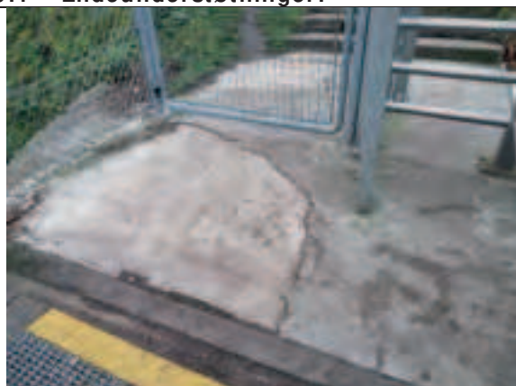
Foto 71: Endeunderstøtning og indgang til fortet i vestlige ende af bro. Afskallet belægning udført som cementbaseret pudslag.
