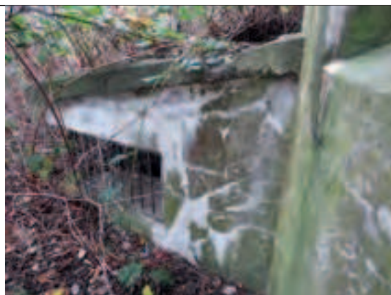
Foto 72: Endeunderstøtning i sydvest (bunker): Gennemsivninger og hvide kalkudfældninger i betonen.
