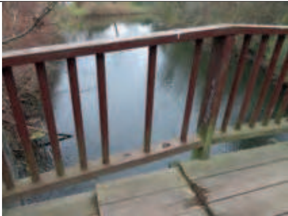
Foto 55: Balustre knækket pga. råd i træet som skyldes en dårlig samlingsdetalje, hvor de er iboret fodliste, hvor vandet trænger ind i træet og dermed får træet til at rådne.
