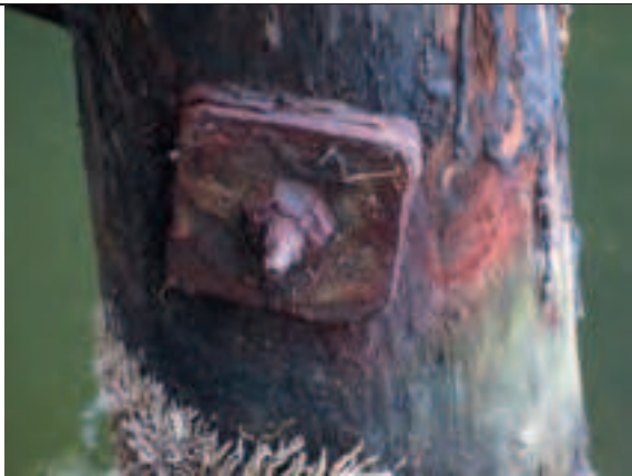
Foto 65: Kraftig korrosion i fastgørelsesbeslag til krydssamling i mellemunderstøtning.
