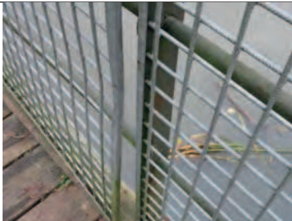
Foto 21: Pressegitter ikke fastgjort og børn kan dermed falde igennem, hvis de løfter pressegitteret.
