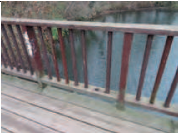
Foto 57: Balustre knækket pga. råd i træet fra dårlig samlingsdetalje.
