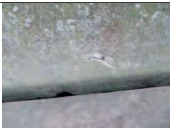
Foto 47: Overløbs konstruktion er ikke bygget sammen med broen. Enkelt lille dæklagsskade.
