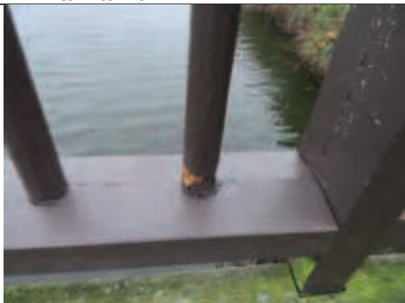
Foto 75: Balustre knækket pga. råd under ny overfladebehandling, hvilket skyldes vand trænger ind i fodlisten ved iboret balustre.
