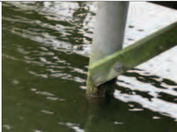
Foto 36: Lettere forvitring af mellem understøtning ved vandniveau.
