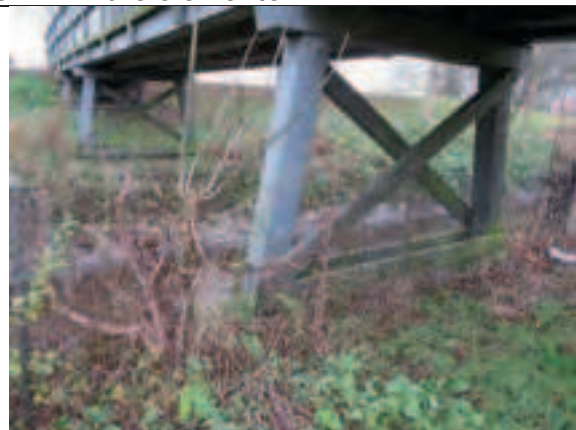
Foto 13: Hegn ødelagt i østlige side (hærværk), hvilket bør repareres. Bevoksning omkring bro bør generelt fjernes.
