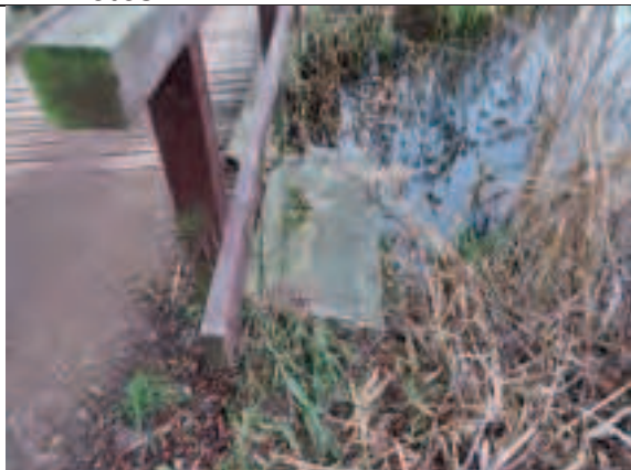
Foto 44: Betonfløj i sydvest vælter udad, hvilket formodentlig skyldes underminering.
