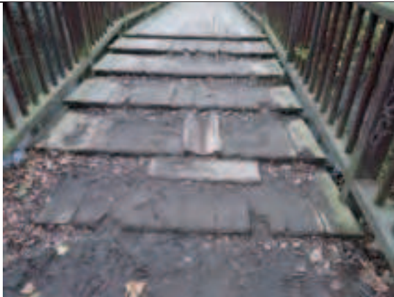
Foto 49: Brodæk i øst er i meget ringe stand. Flere planker knækket og flere med råd
