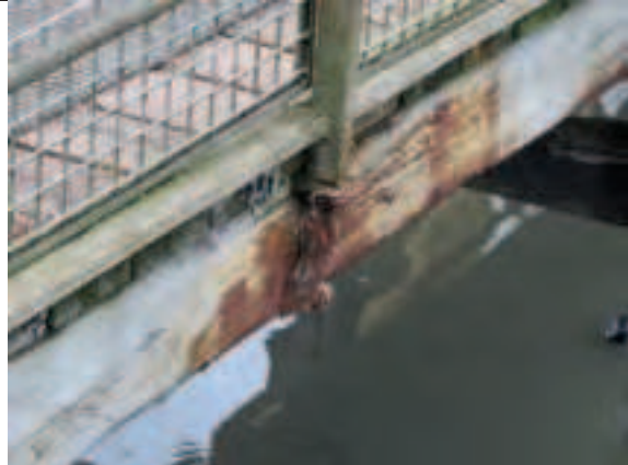
Foto 20: Kraftig korrosion i fastgørelse af rækværkscepter.
