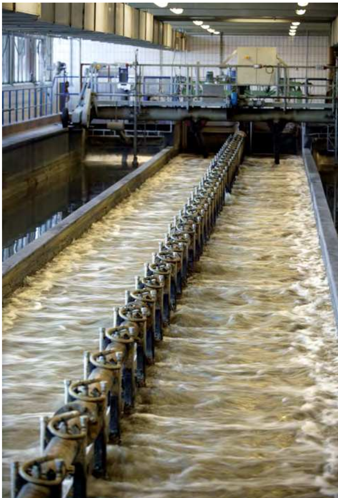
Foto 7 Sandfang på Strandvængets Pumpestation
