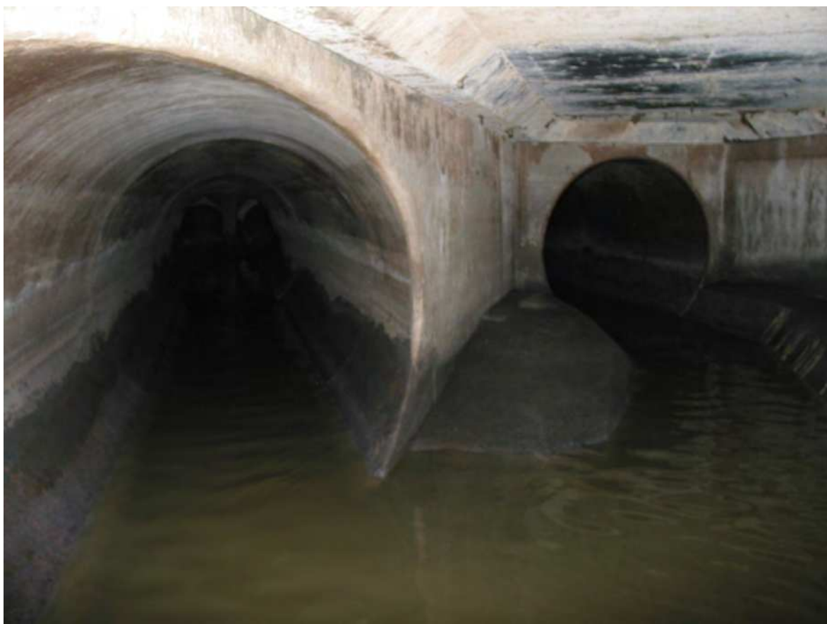
Foto 11 Ledningssammenskæring. To ledninger løber sammen til een
