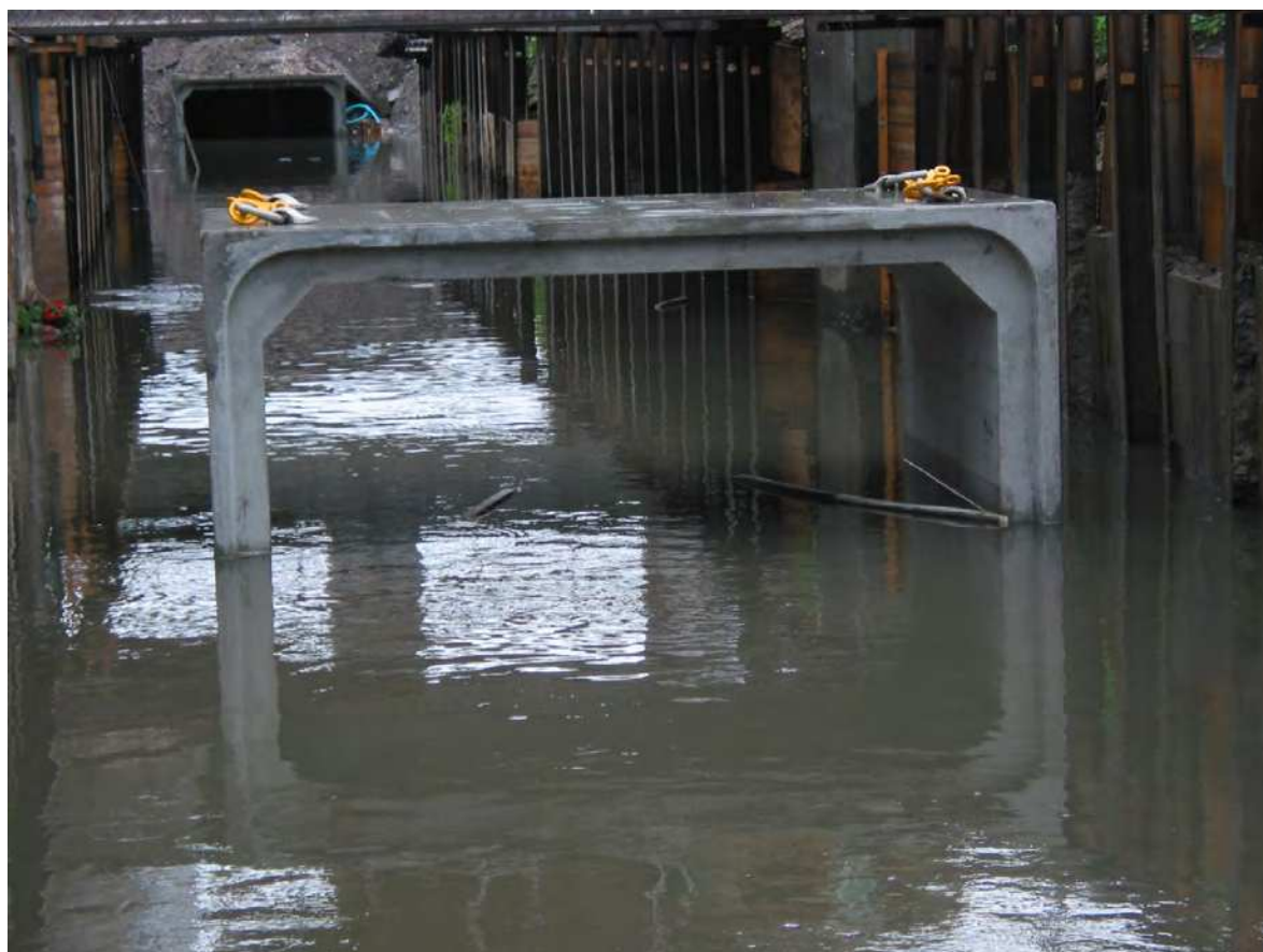
Foto 12 Oversvømmelse af anlægsarbejder på Lersøgrøften
