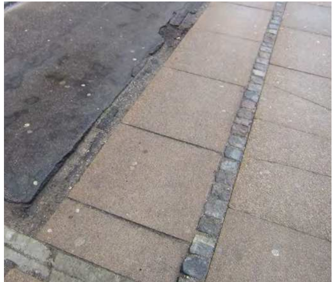
Foto fra Mellemtoftevej. Vand fra åbne vandrender har frostsprængt den omgivende belægning.
