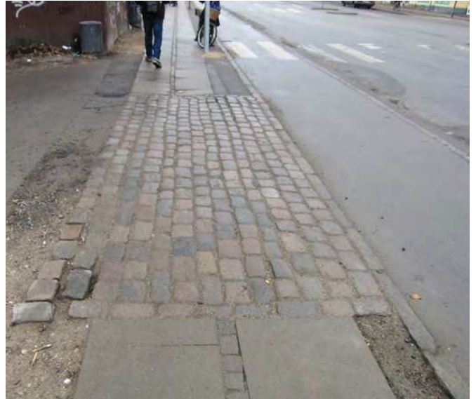
Foto fra Valby Langgade. Udligningszone mangler.
