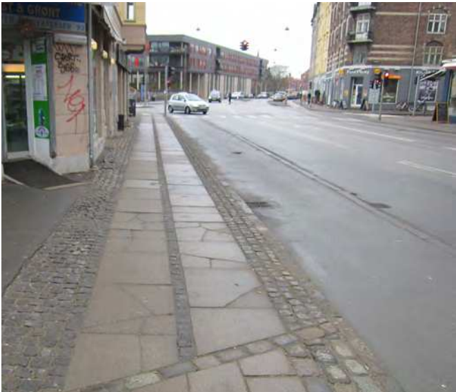
Foto fra Valby Langgade. Parkerede biler har måske ødelagt fortovsfliserne.
