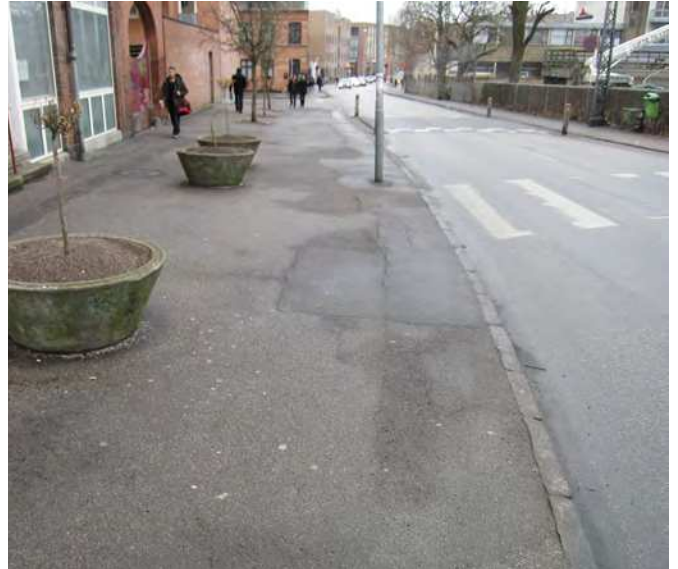
Problem 18_1: Asfaltfortov på Rughavevej ved Mellemtoftevej
