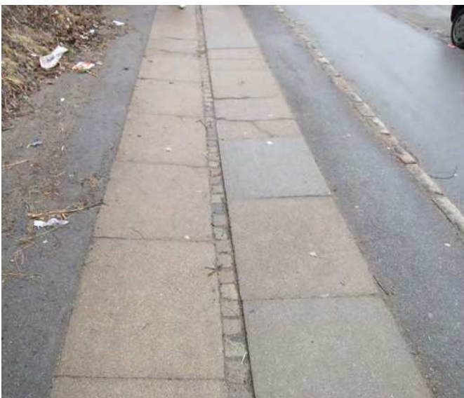
Foto fra Valby Langgade. Fortovet er måske undermineret og er sunket på midten.
