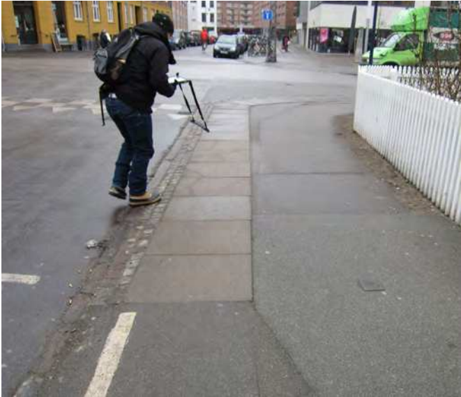
Problem 18_1: Asfaltfortov på Skolegade ved Annexstræde
