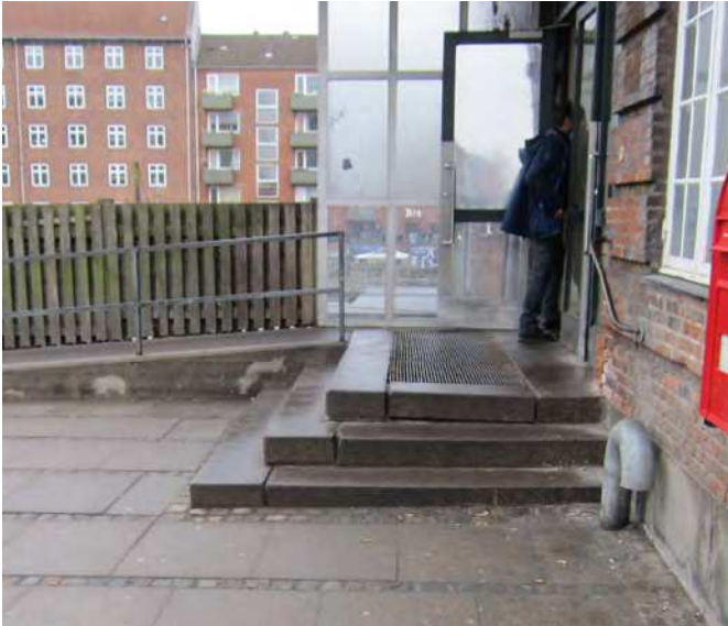
Foto der viser problem 12_1: Trappe
