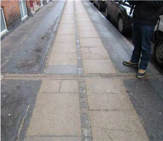
Foto der viser problem 02_1: synlig vandrende i for-tov.
