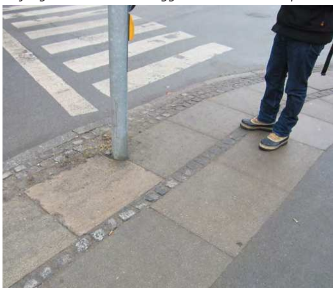
Problem 08_3 + 08_4: Opmærksomhedsfeltet på billedet er ikke dybt nok og mangler kontrastfarve og mærkbare knopper. Desuden ligger det i niveau med kørebanen.
