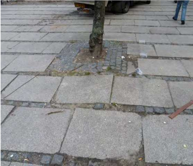
Foto fra området omkring Valby Medborgerhus. Træernes rødder bryder belægningen.
