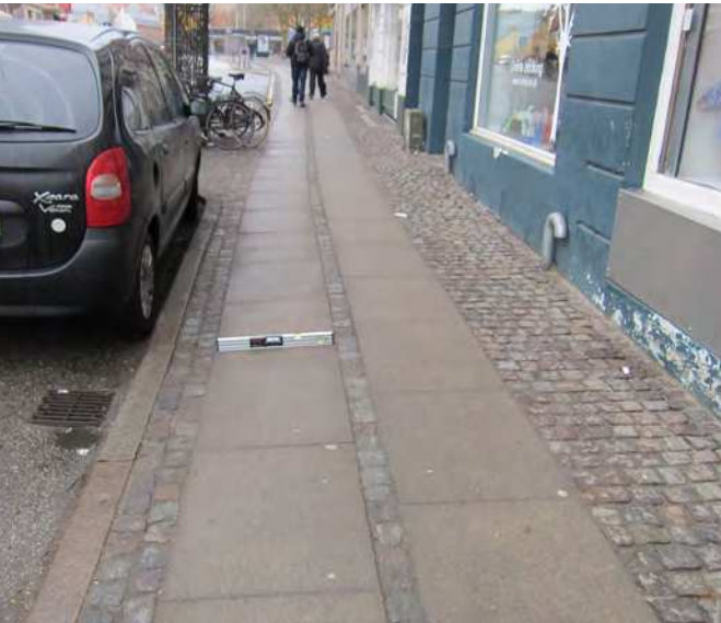
Problem 10_2: Udadgående tværfald. Her på billedet er tværfaldet målt til 61‰ (ca. 1:16).
