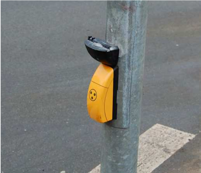
Foto der viser akustisk signal med retningsviser i toppen - Hér hvor der er midterhelle.
