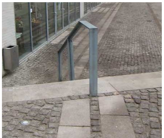
Foto der viser problem 13_4: Trappeanlæg
