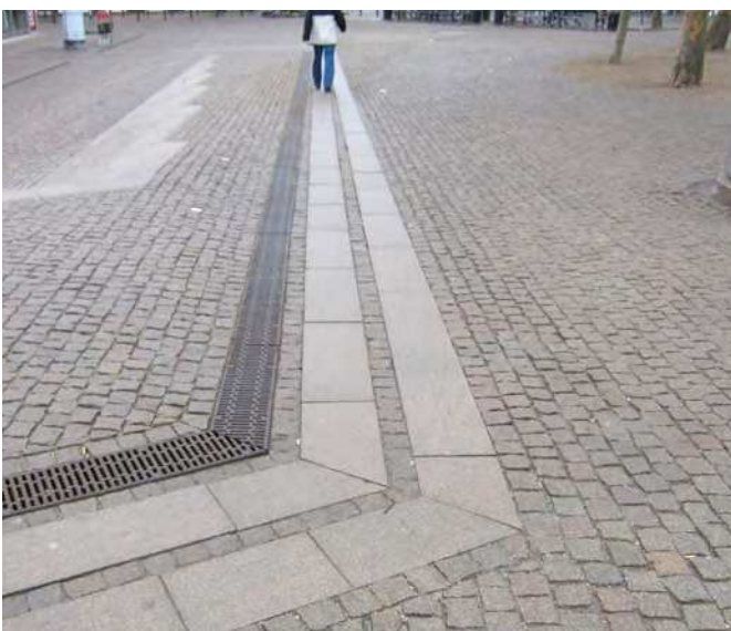
Foto der viser problem 13_3: Gangbanebredde
