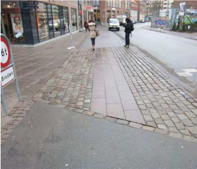
Problem 03: Asfaltfortov, her foto fra Annexstræde.
