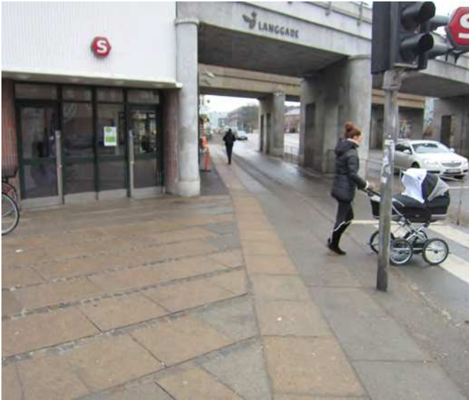
Problem 14_1: Gangbaner uden retning samt manglende ledelinier i fortovet
