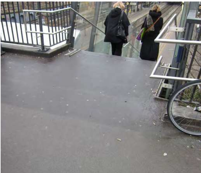
Problem 17_3: Manglende opmærksomhedsfelter ved trapper
