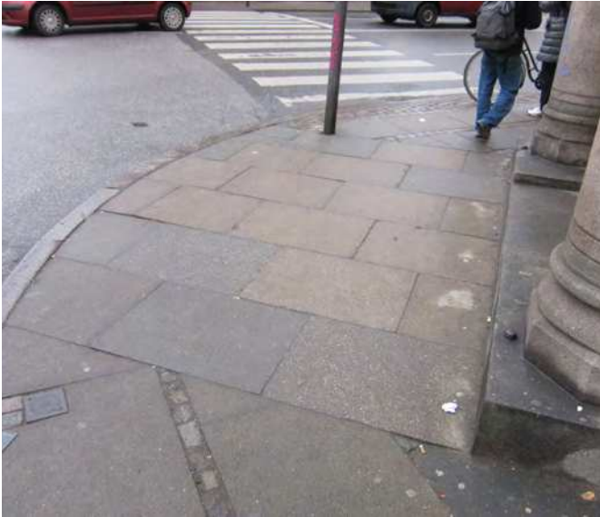
Problem 05_1: Fortovsledelinie føres ikke med rundt om hjørnet.
