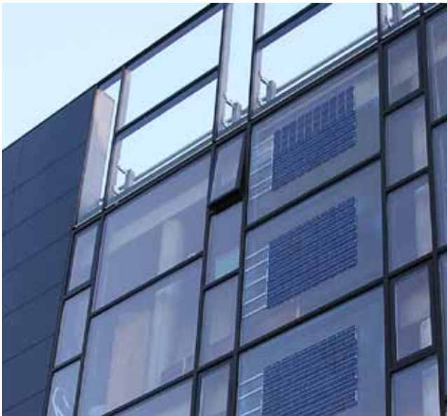
Solpaneler i glasfacade Dannebrogsgade 49
