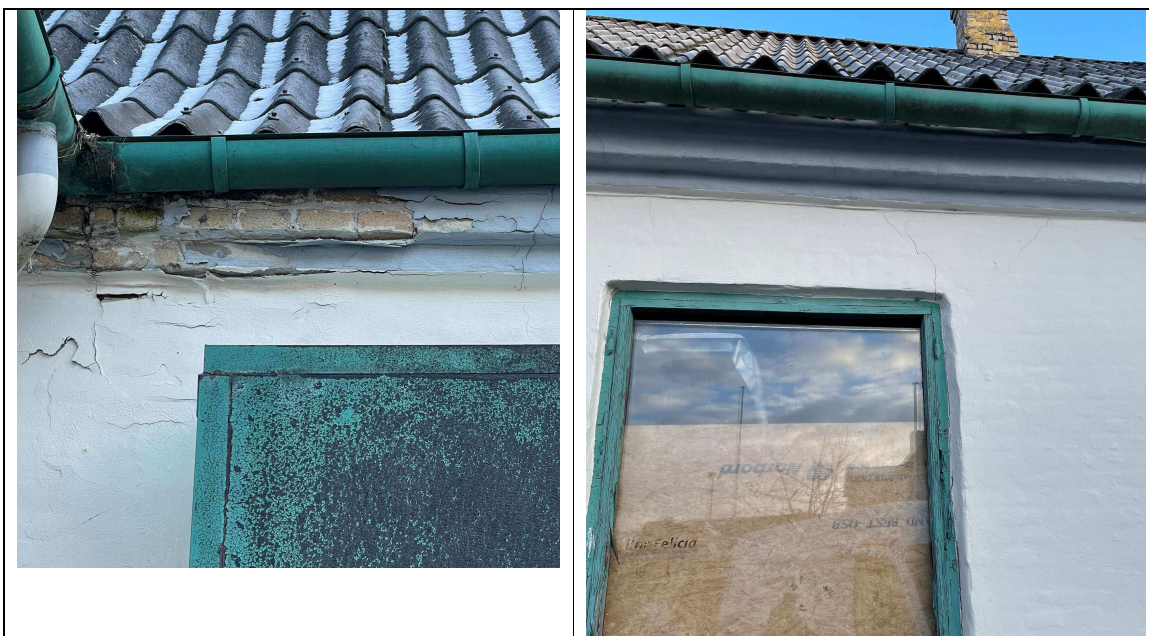
Billede 7 - Revner og opfugtet murværk
