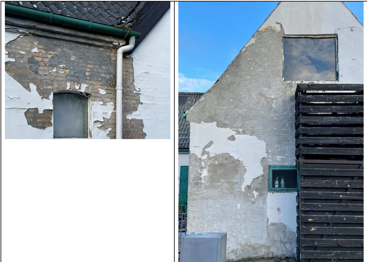
Billede 8 – Bygning 2 Fugtpåvirket murværk
