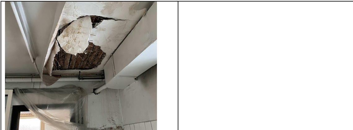
Billede 9 - Fugtskade indvendig grundet utæt tag
