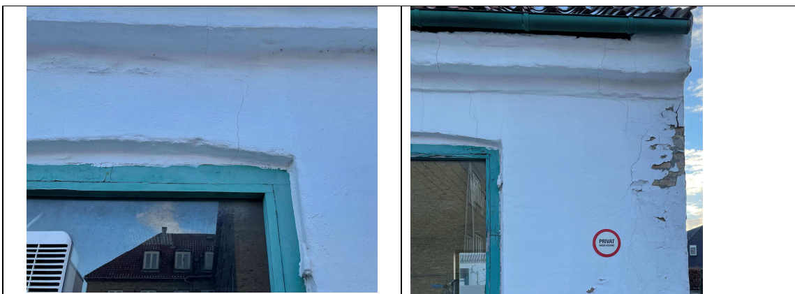
Billede 2 – Bygning 1 Revner omkring døre og vinduer
