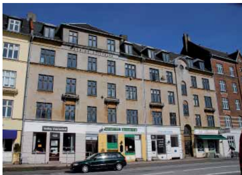
Ejendommen Valby Langgade 120 er et godt eksempel på en bygning med lav udvendig tilstand, som kan søge tilskud til byfornyelse.
