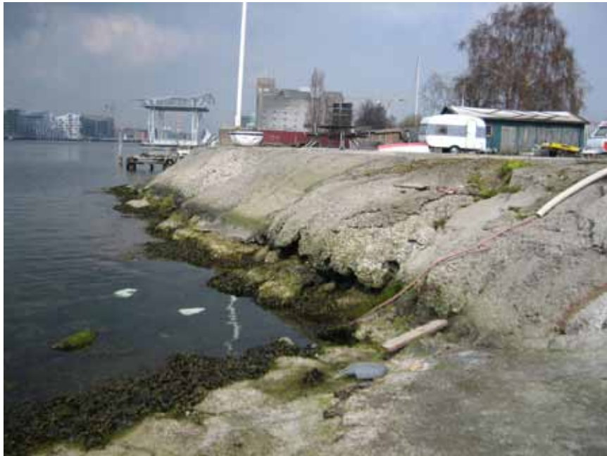
Betonkanten der flyder ud
