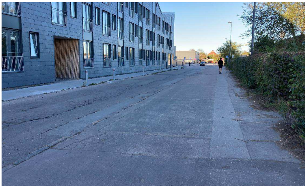
Figur 3-4 Julius Andersens Vej ved Hafniakollegiet. Belægningen er slidt og ødelagt flere steder, og det brede fortovsareal næsten i niveau med kørebanelen indbyder til (ulovlig) parkering.
