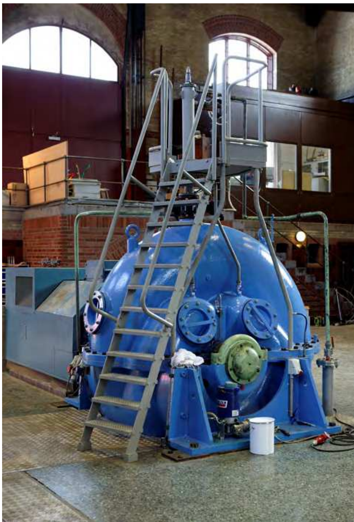
Foto 2 Kløvermarksvej Pumpestation, maskinhallen
