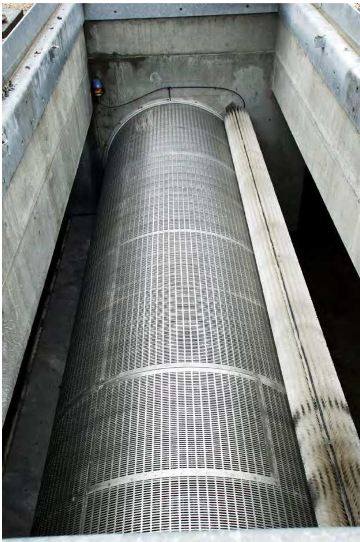
Foto 10 Tromlesi til rensning af overløbsvand inden overløb til Sankt Annæ Plads-bassinet
