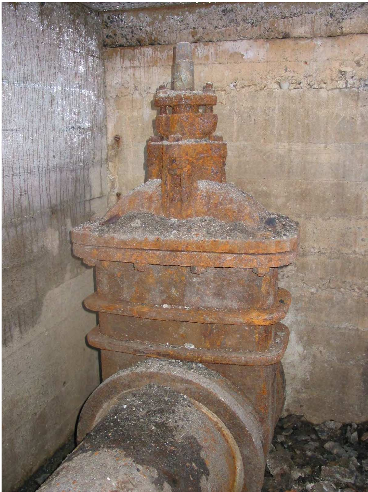
Foto 3 Ventil i bygværk
