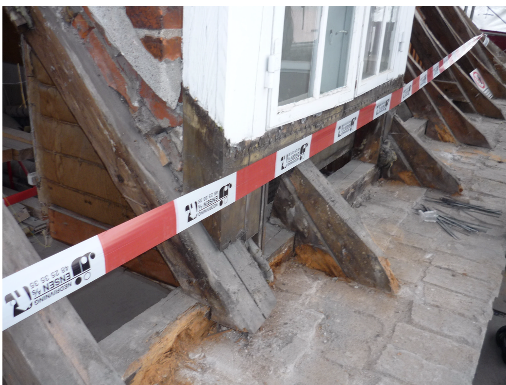
Rådskader i spærender og tagrem i Sundparkbygningen.
