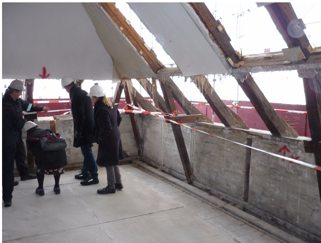
Indvendig tagrum, østlig del af Sundparkbygningen – omfang af svampeangreb.
