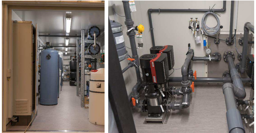
Figur 4-6 Eksempler på indretning af Silhorko vandbehandlings container.
